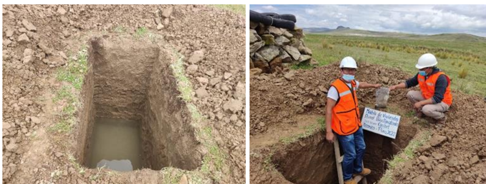
Figura 60: Identificación, Excavación y obtención de muestras del suelo para el proyecto – Viluyo, Pichacani, Puno, 2022.
