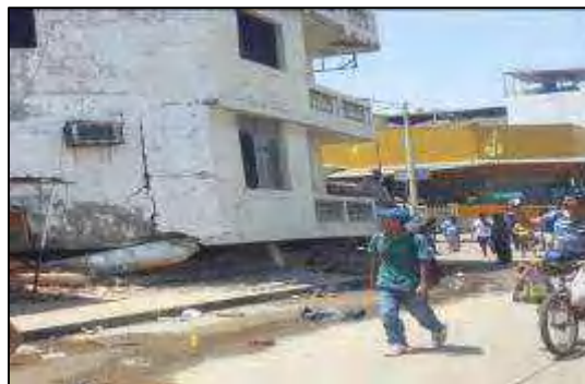
Figura 5. Falla debido a Piso Blando.
