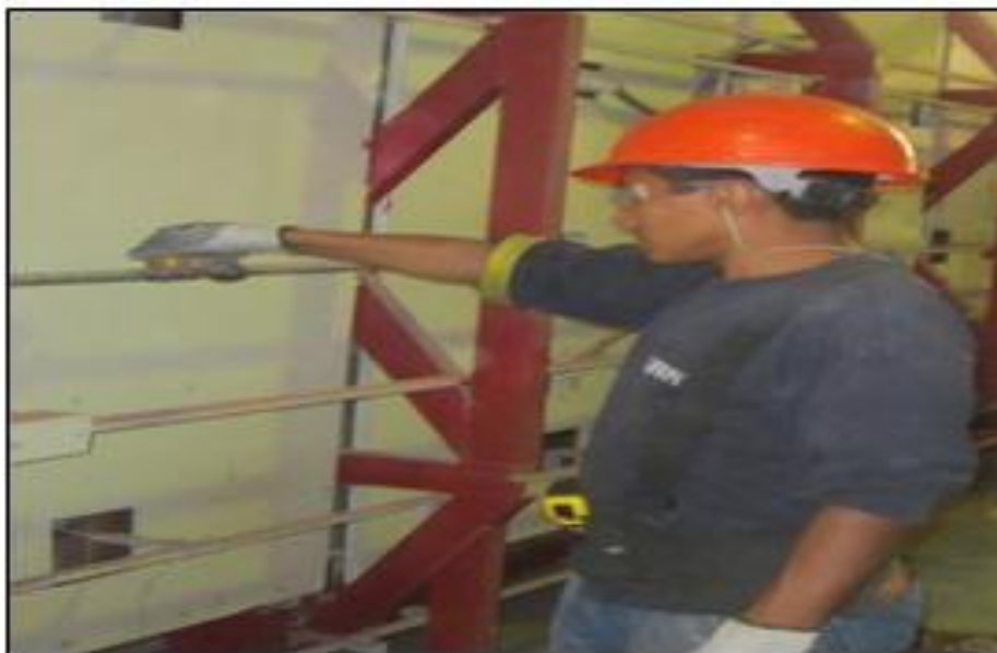
Ilustración 3. Verifica las llaves y válvulas antes del encendido
