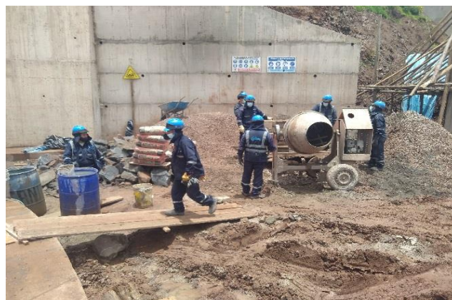
Figura 16. Mitigación de ruidos y generación material particulado en los trabajos de preparación de concreto
