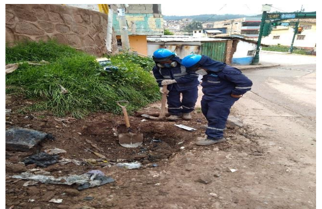
Figura 18. Uso de EPP's para mitigar la contaminación por emanación de gases producto de la descomposición de RRSS soterrados
