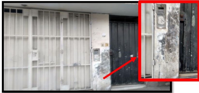
Figura 1. Presencia de humedad y salitre en las viviendas del AA. HH San Antonio
