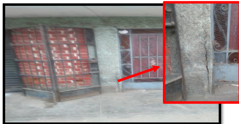
Figura 2. Presencia de fisuras en los elementos estructurales de las viviendas del AA. HH San Antonio
