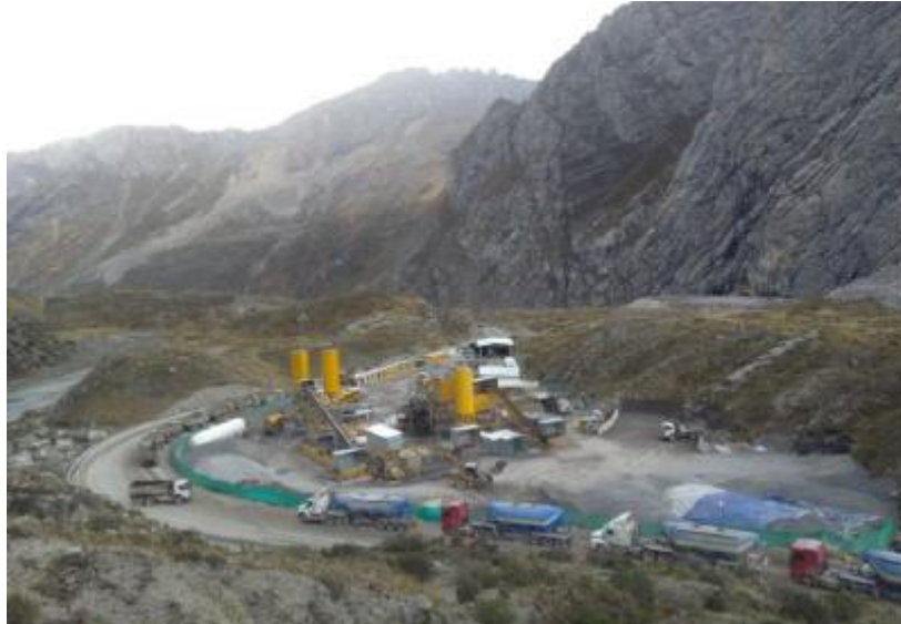
Planta industrial UNICON, instalada en la zona de sierra del Perú
