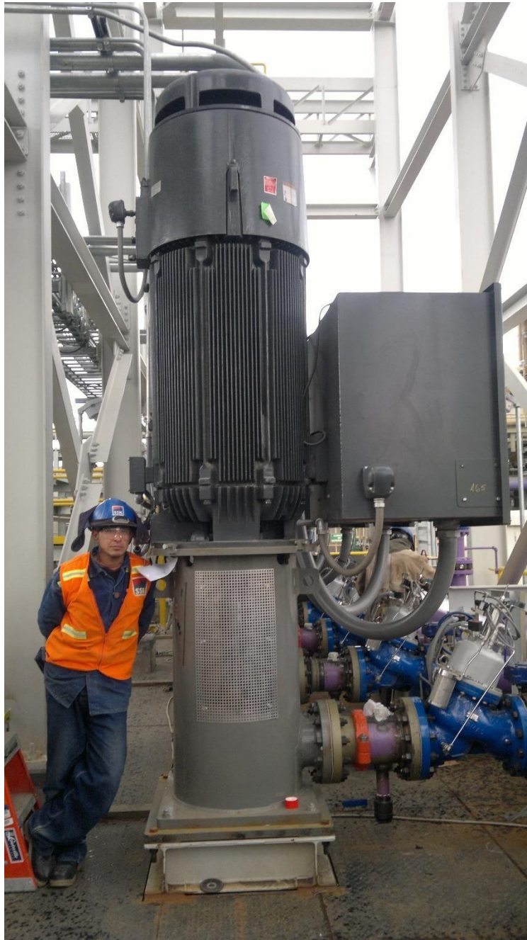
FOTO 01, Bomba de turbina vertical y acoplamiento válvula de retención y cierre progresivo.
