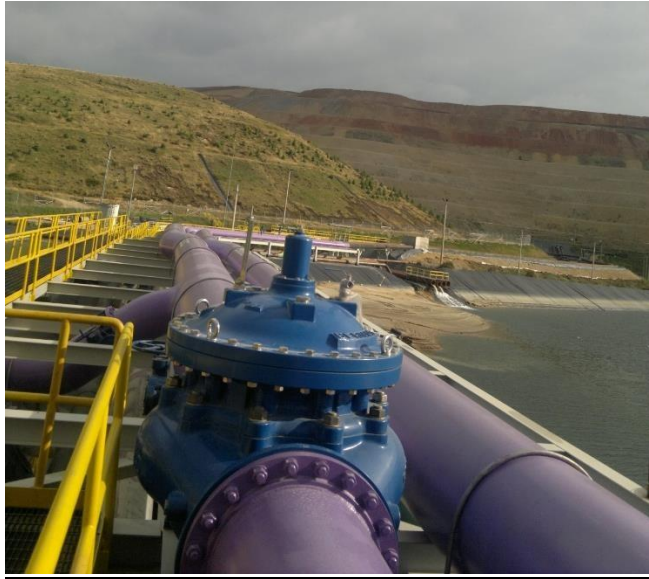
FOTO 05, Válvula con dispositivo anti cavitación montada en tubería de 24" vista de dirección al Pad LQ8.
