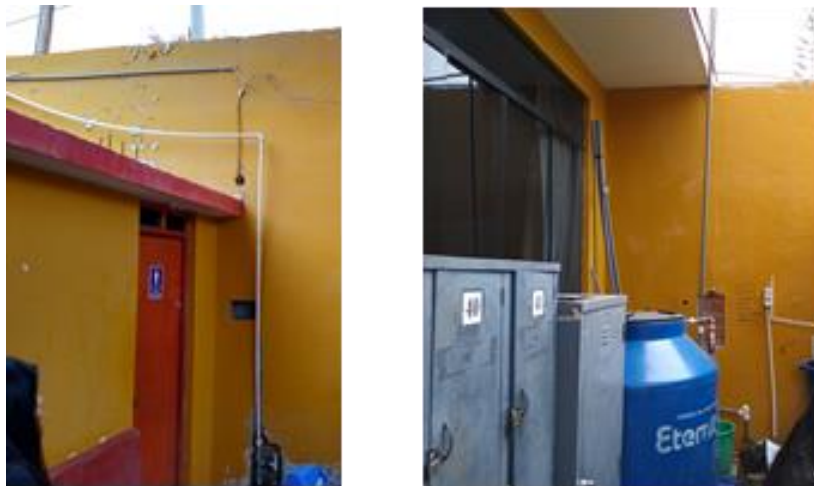
FIGURA 26: Insuficiencia de espacios y exposición a peligros
