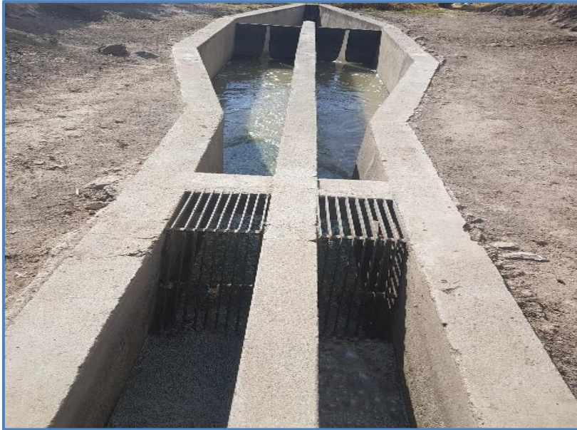
Figura 17. Vista del estado actual de rejas
