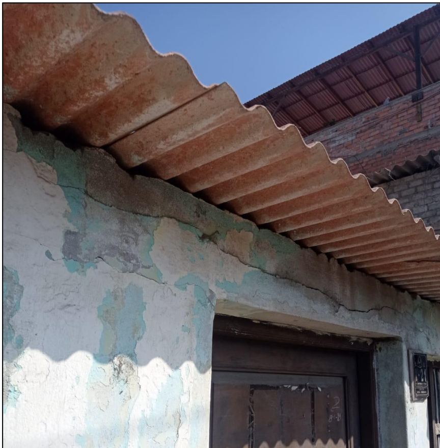
Foto 14. Grietas presentadas en vivienda I21.
