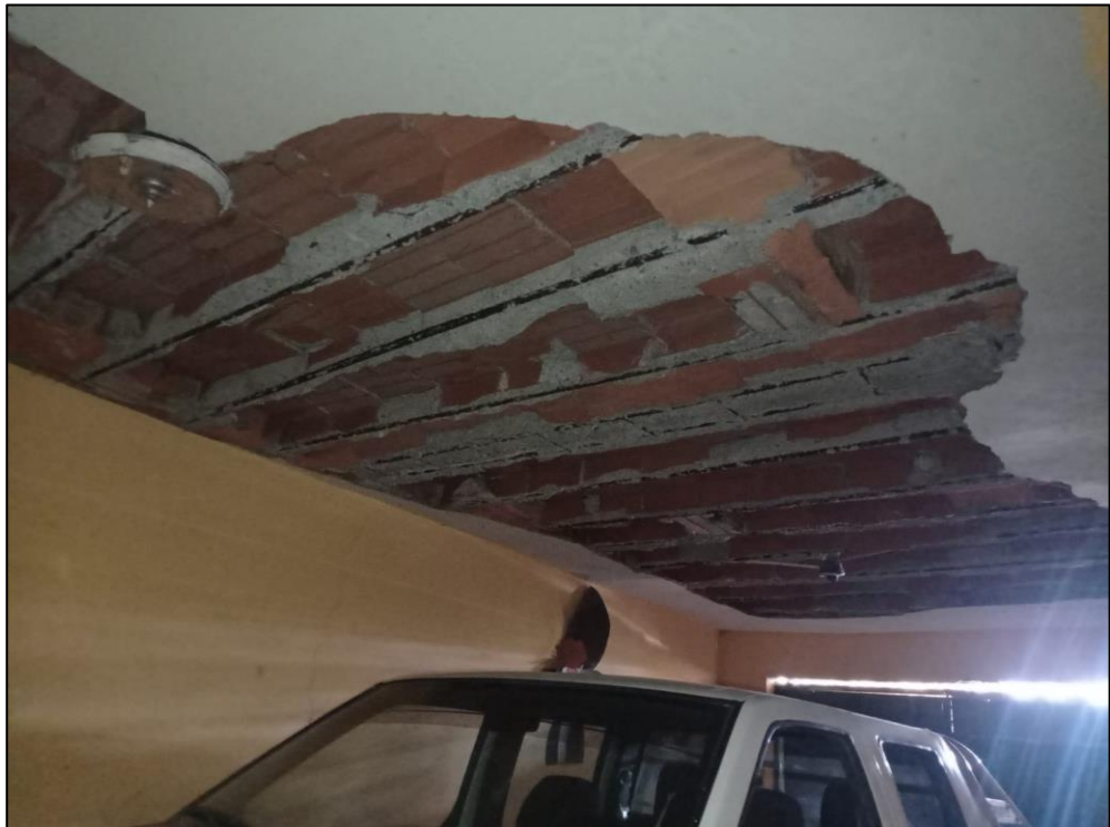
Foto 18. Desprendimiento de ladrillos y tarrajeo de losa.
