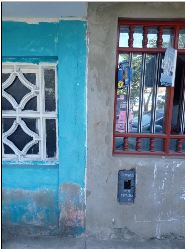
Foto 20. Vivienda sin ninguna junta sísmica.
