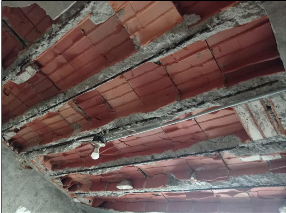
Foto 17. Acero de vigueta oxidado y desprendimiento de ladrillos y tarrajeo de losa.
