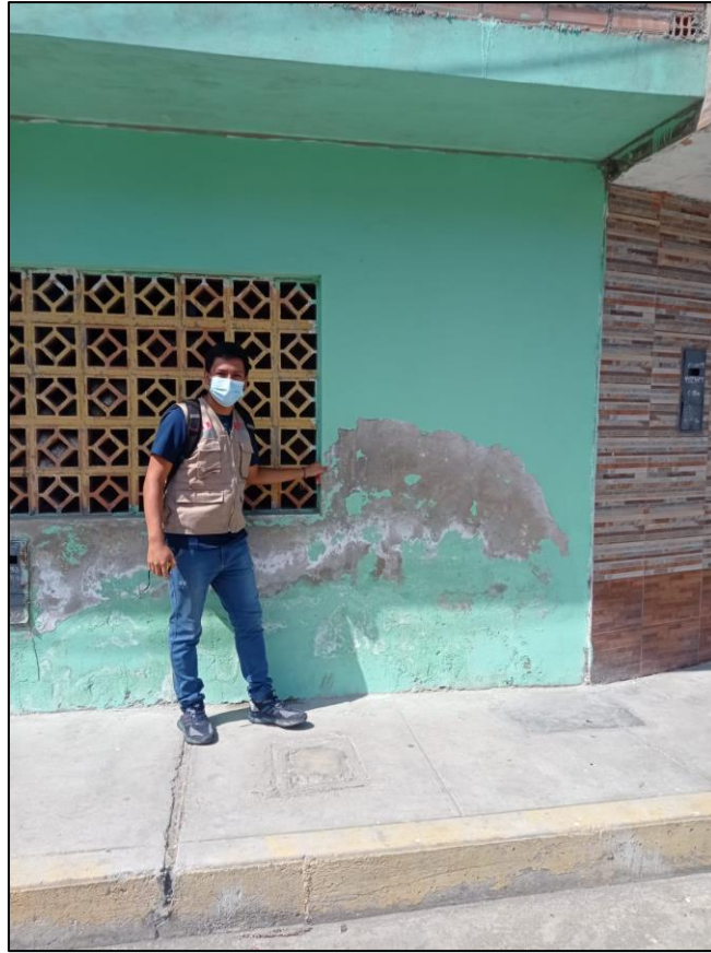
Foto 15. Eflorescencia a una altura de 1.50m en fachada de vivienda.
