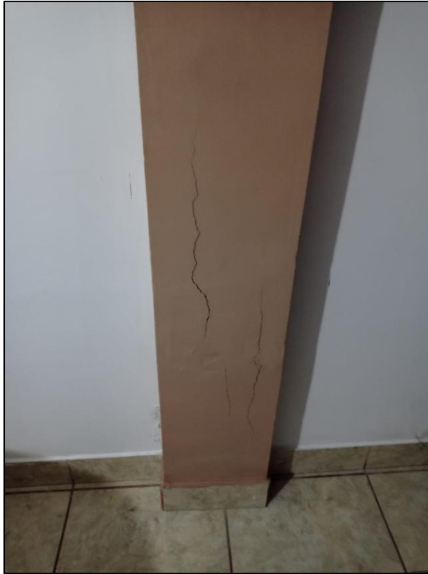
Foto 23. Presencia de grietas en columna.
