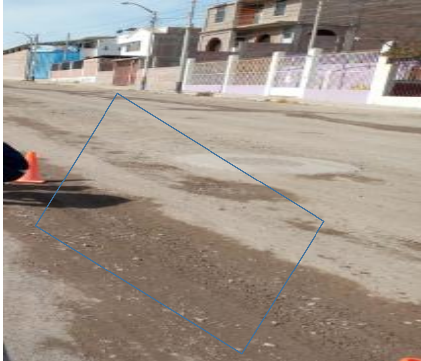
Figura 21. Falla n 3, Elaboración Propia.
