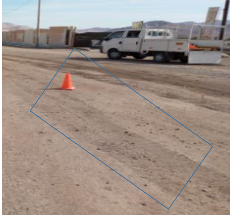
Figura 19. Falla n1, Elaboración Propia.
