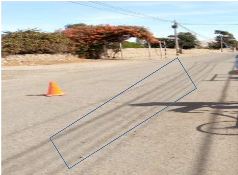
Figura 27. Falla n 9, Elaboración Propia.
