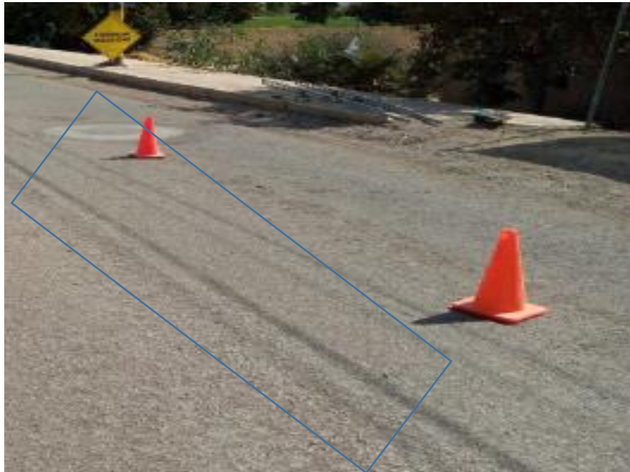
Figura 24. Falla n 6, Elaboración Propia.
