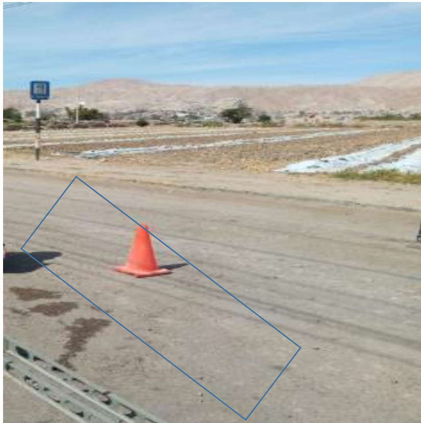
Figura 26. Falla n 8, Elaboración Propia.
