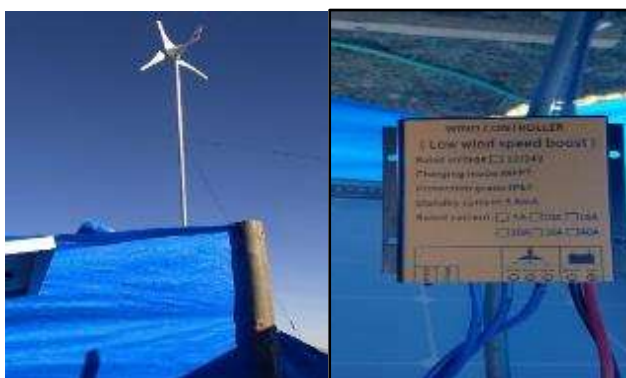
Figura 53, 54 funcionamiento del generador eólico y so controlar de energía
