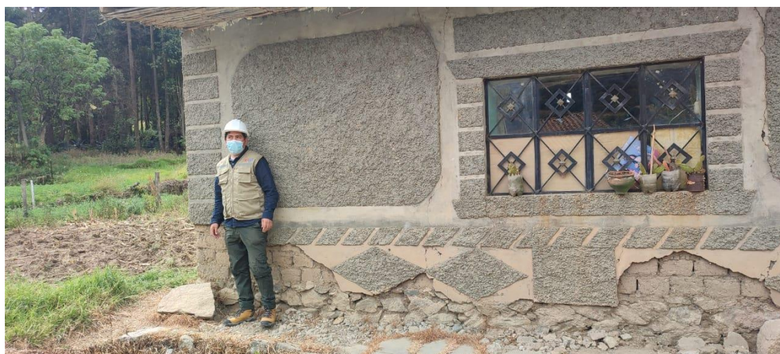
Figura 57. Caída del recubrimiento en la parte inferior de los muros
