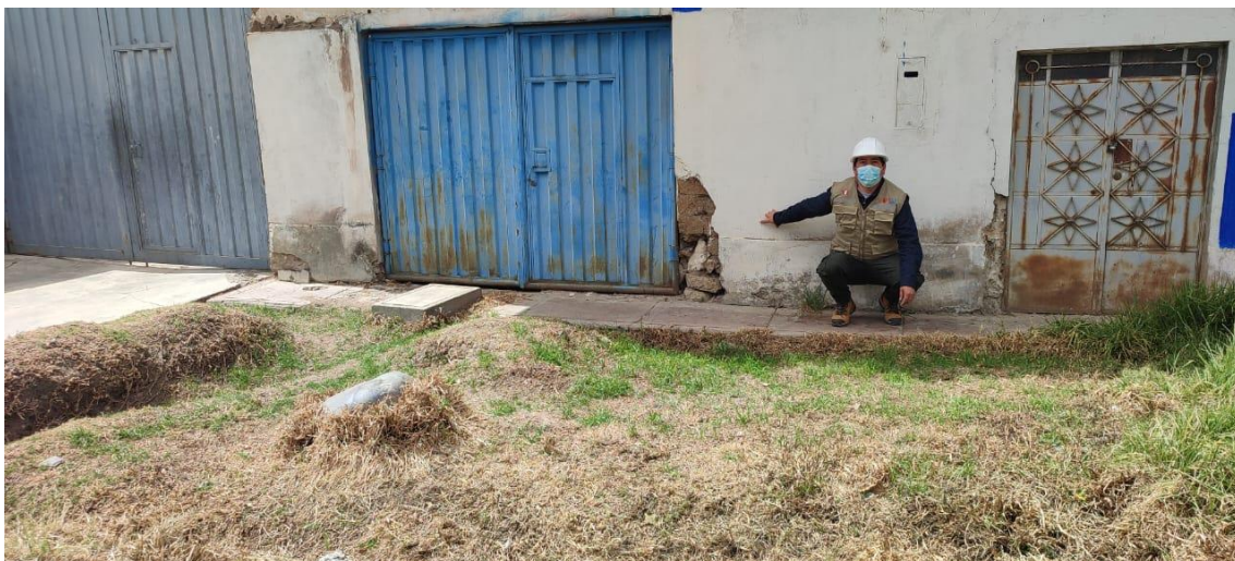
Figura 59. Caída del recubrimiento en la parte inferior de los muros
