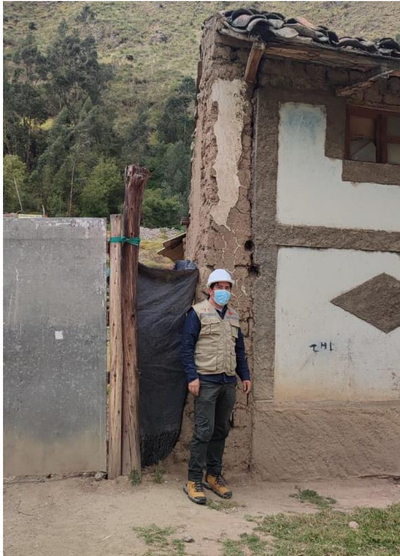
Figura 58. Grietas verticales en encuentro de muros
