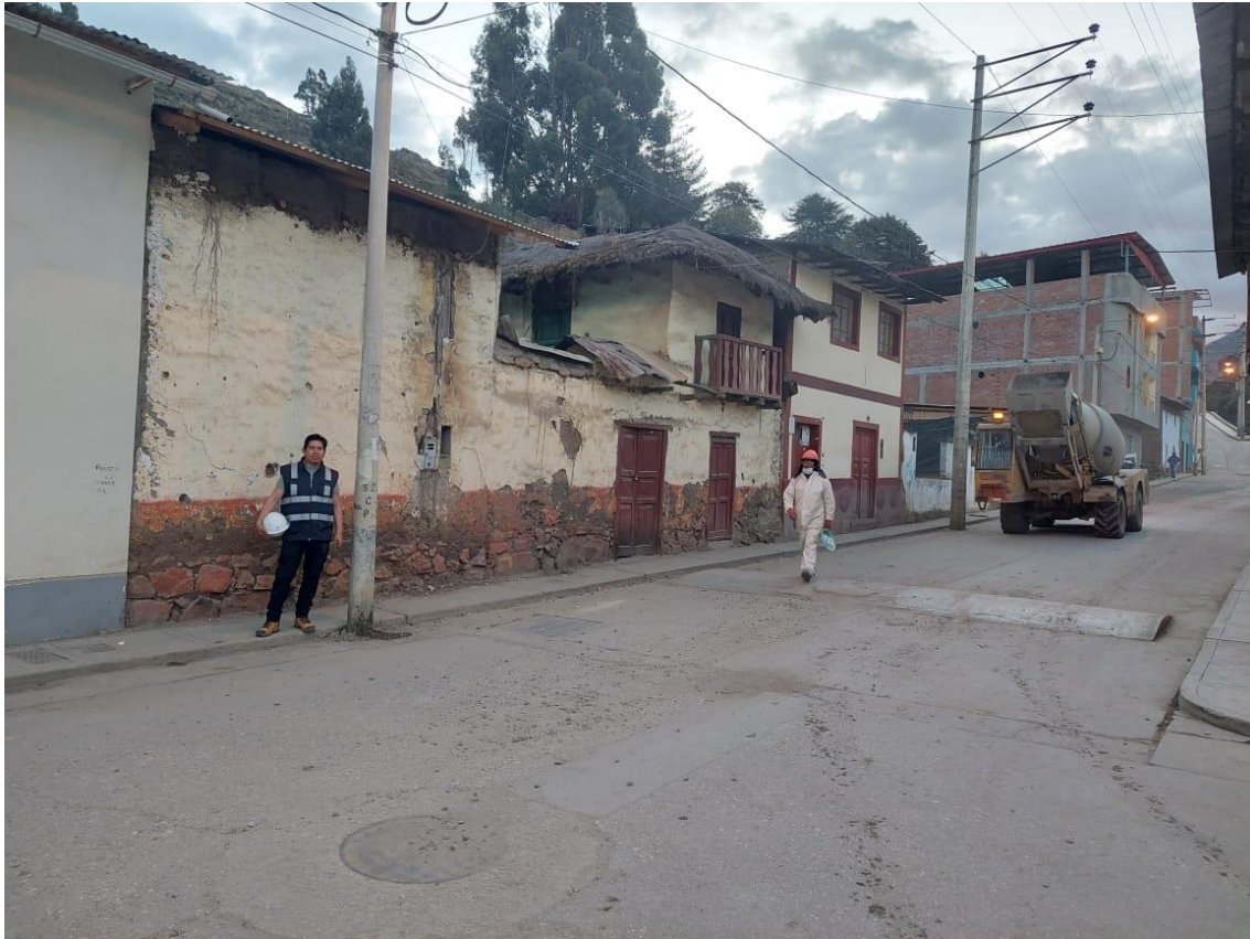
Figura 65. Colapso parcial de muros
