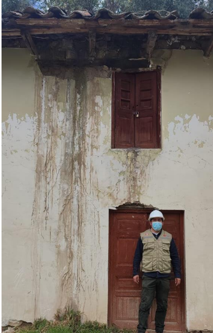
Figura 63. Grietas verticales en el centro superior de los muros y tímpanos altos
