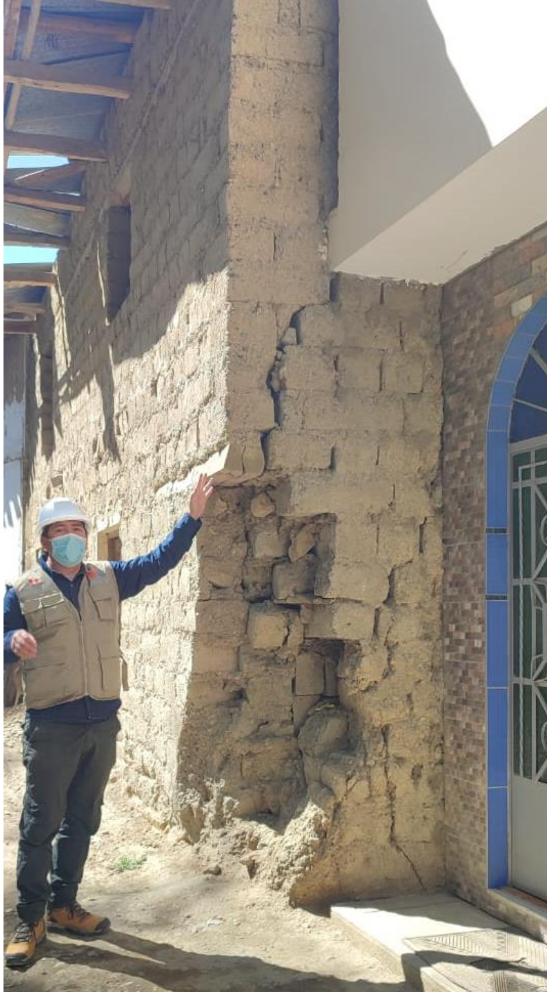
Figura 62. Colapso parcial de muros
