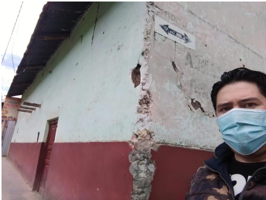
Figura 61. Grietas en encuentro de muros de material incompatible
