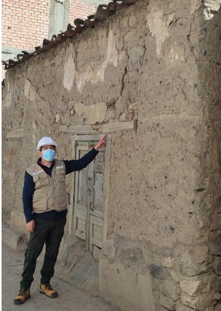
Figura 60. Grietas diagonales en muros
