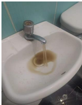
Foto 14: Llegada del agua a las viviendas en épocas de lluvia.
