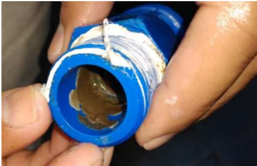
Figura 12. Tubería de línea de tratamiento con sarro.
