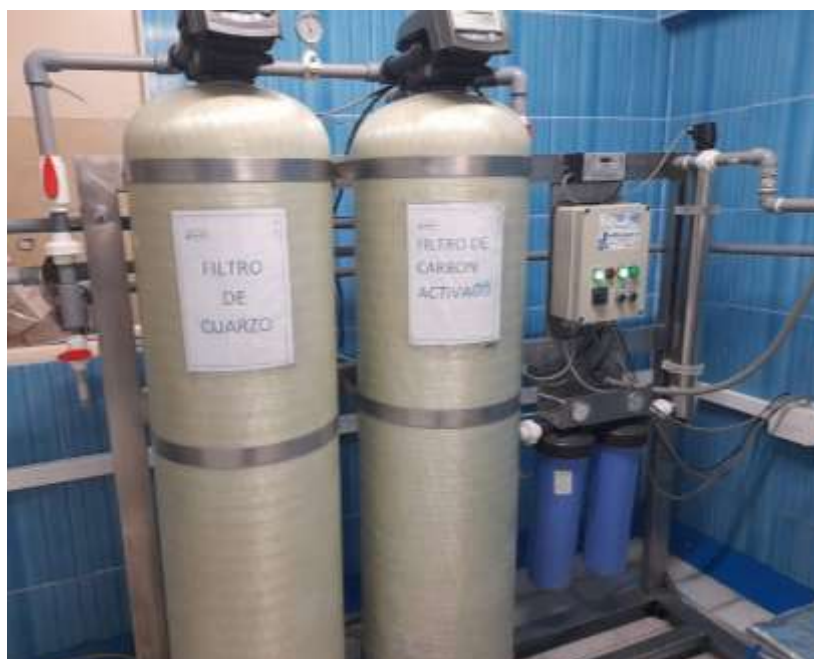
Figura 7. Filtro de cuarzo, carbón y filtros finos.
