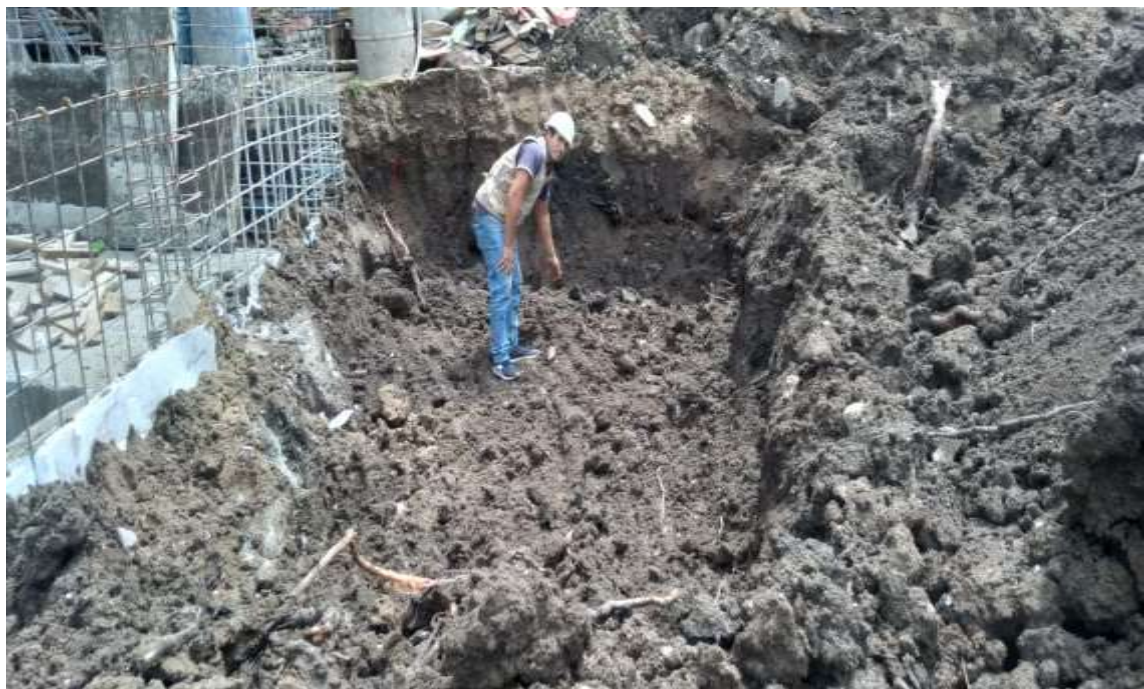
IMAGEN 04 Se finaliza la extracción del suelo considerando un suelo de tipo S2
