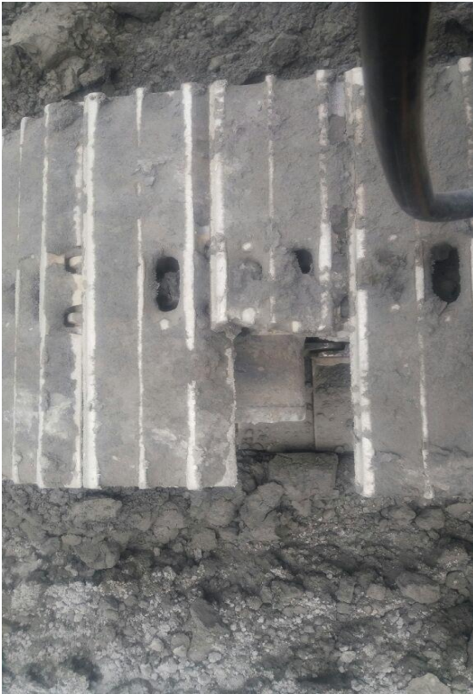
Figura 29: Rotura de zapatas del carril
