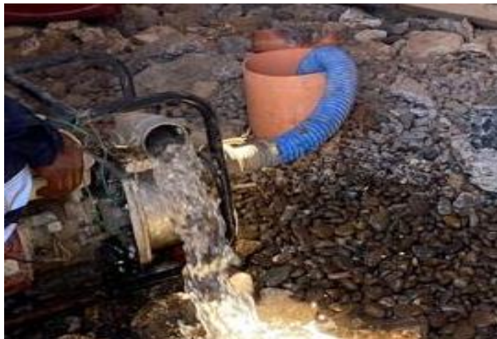
Figura 24: Vista del bombeo de agua.
