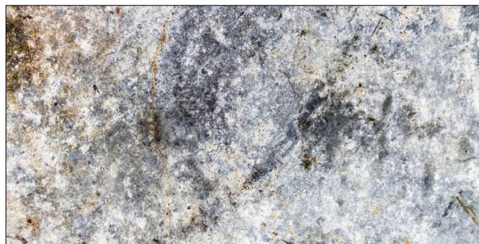
Figura 4. Deterioro del concreto por acción de sales.
