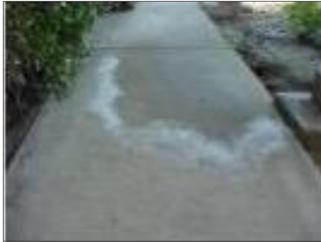
Figura 3. Corrosión de una acera debido a agentes químicos - sales.
