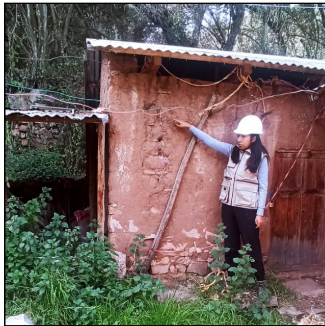
Figura 2: Cárcavas por desgaste en muro
