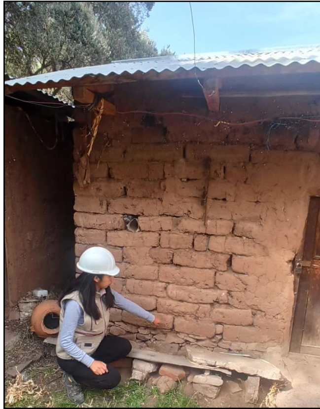
Figura 3: Fisuras en base de muro de adobe.
