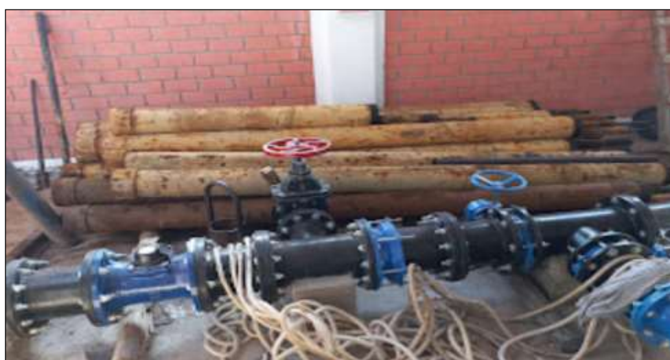
Figura 2. Columnas de la bomba del pozo.
