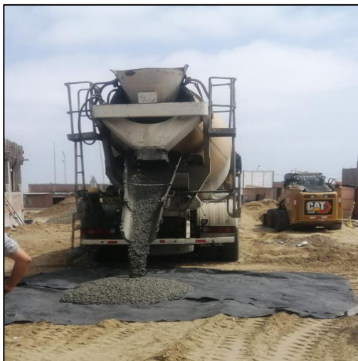
Figura 5. Pedido de concreto excedido
