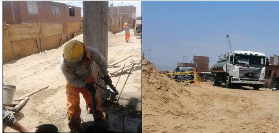
Figura 3. Retraso en pedidos de agua
