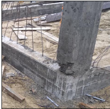
Figura 1. Segregación en vaciado de columnas
