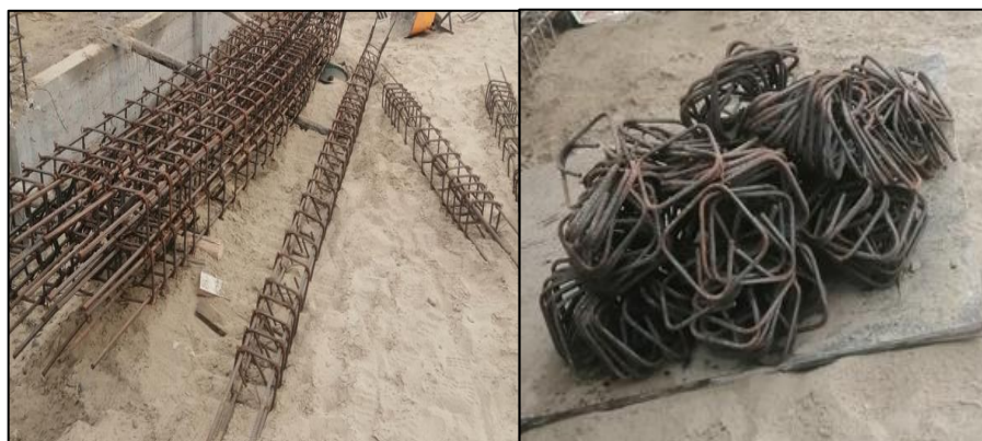
Figura 6. Exceso de acero en columnas y estribos
