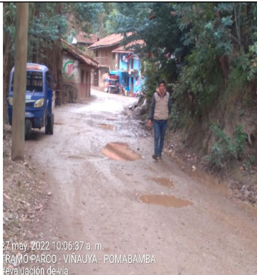
FOTO 1: INSPECCIÓN DE BACHES EN LA VÍA.
