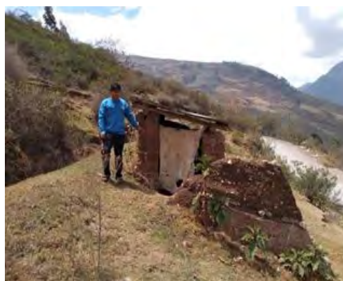
Figura 12. Estado de letrinas existentes
