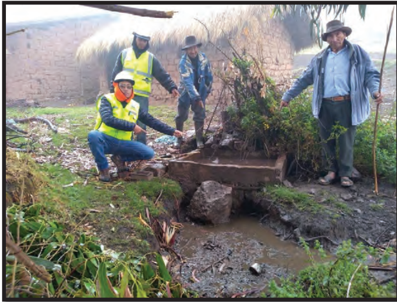
Foto N°9: Se observa que el lavadero se encuentra en estado de deterioro.
