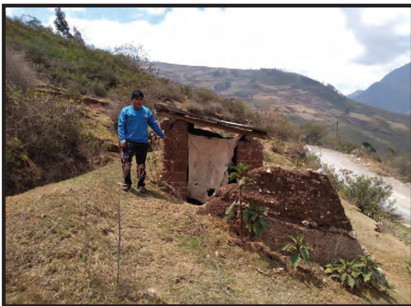
Foto N° 11: los servicio higiénicos se encuentran en un estado deterioro .
