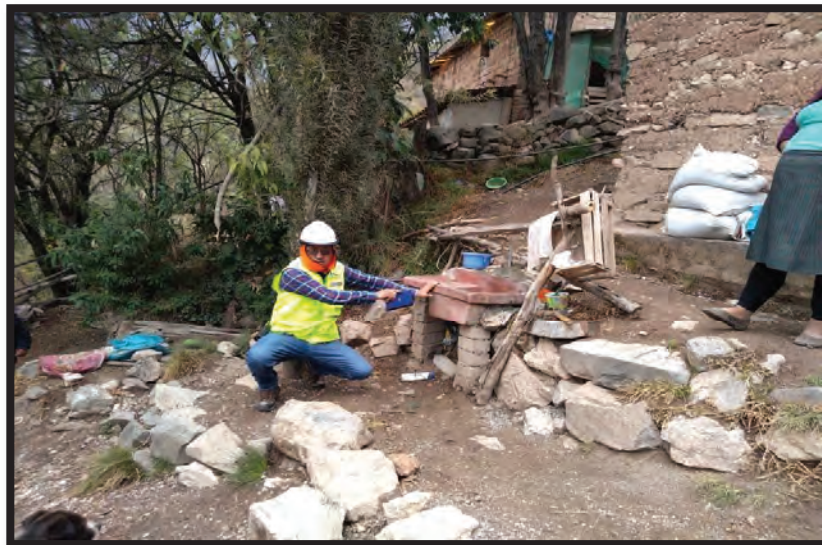
Foto N° 8: Se observa que el lavadero se encuentra en estado de deterioro.
