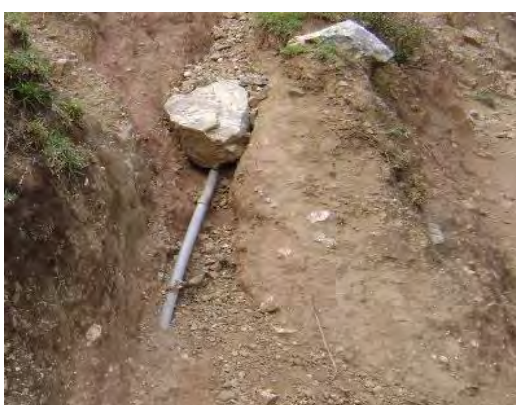
Figura 17. Tuberías de red existentes expuestas al aire libre e instalados al aire libre
