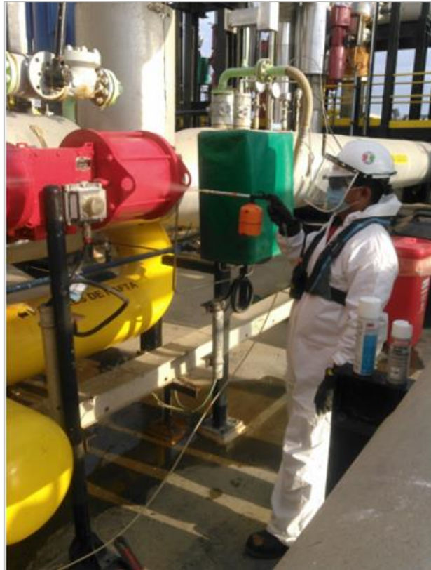
Figura 6. Mantenimiento de actuador
