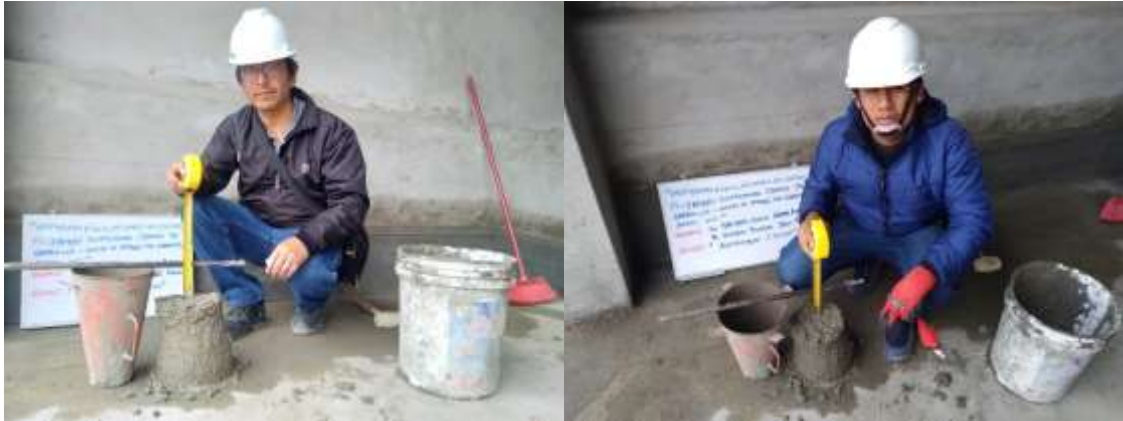
Figura 28. Fotos de asentamiento
