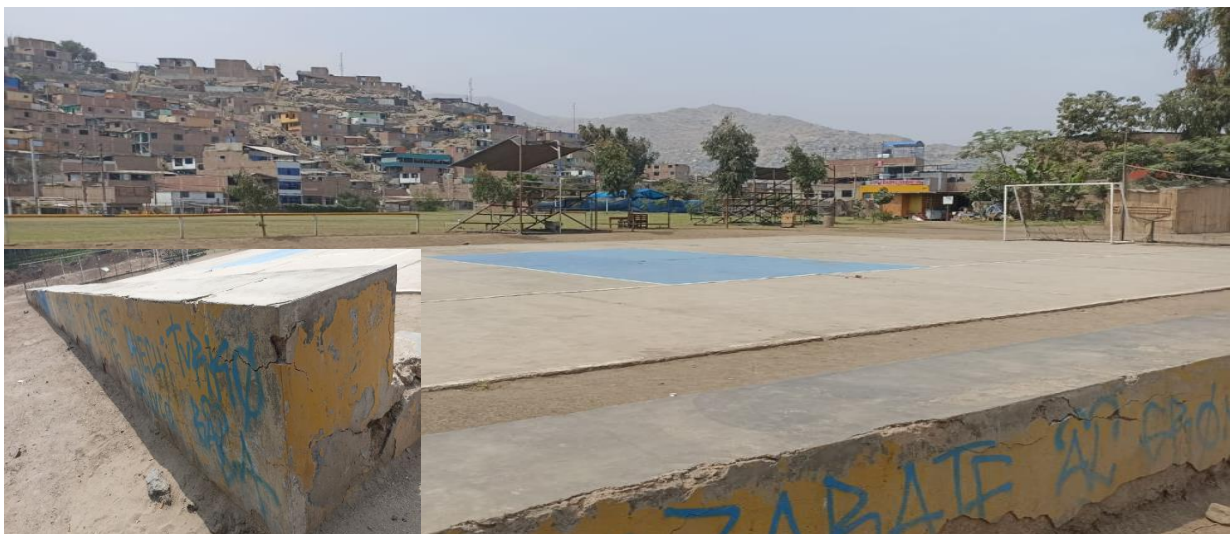
Cruz de Motupe: Estructuras deterioradas
