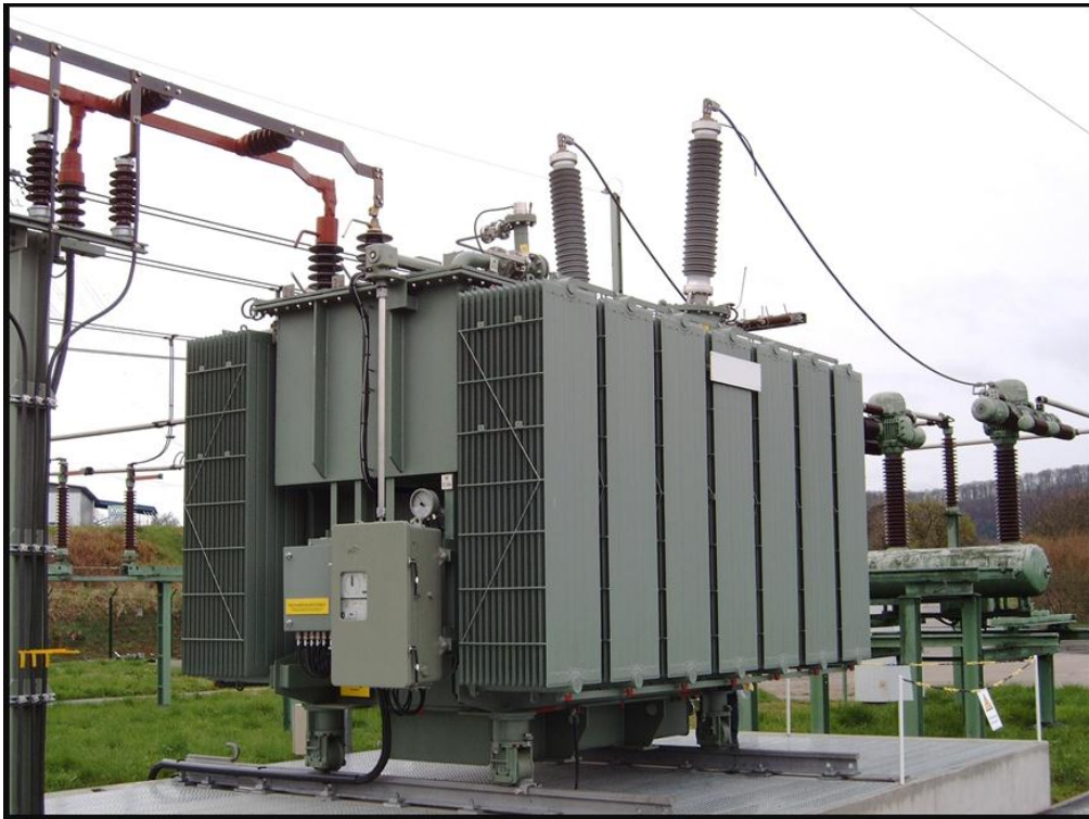
Figura 06: Imagen de un transformador eléctrico de potencia.
