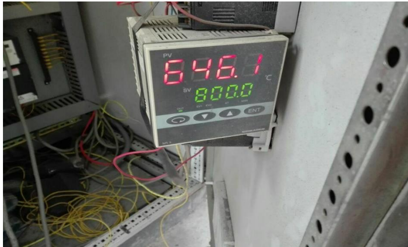
Registrador de temperatura en malas condiciones
