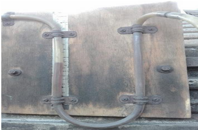
Columna de líquido en el ducto de la chimenea
