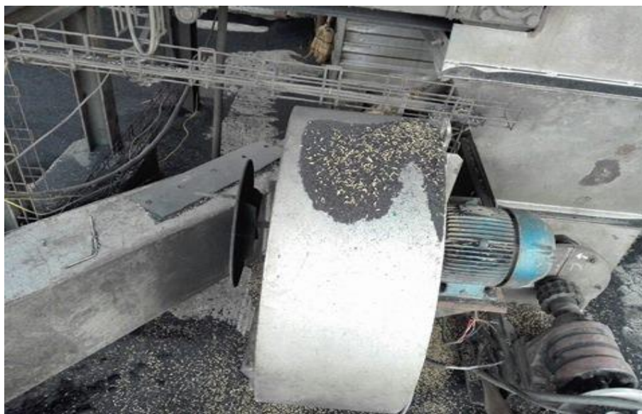
Ventilador de impulsión fragua
