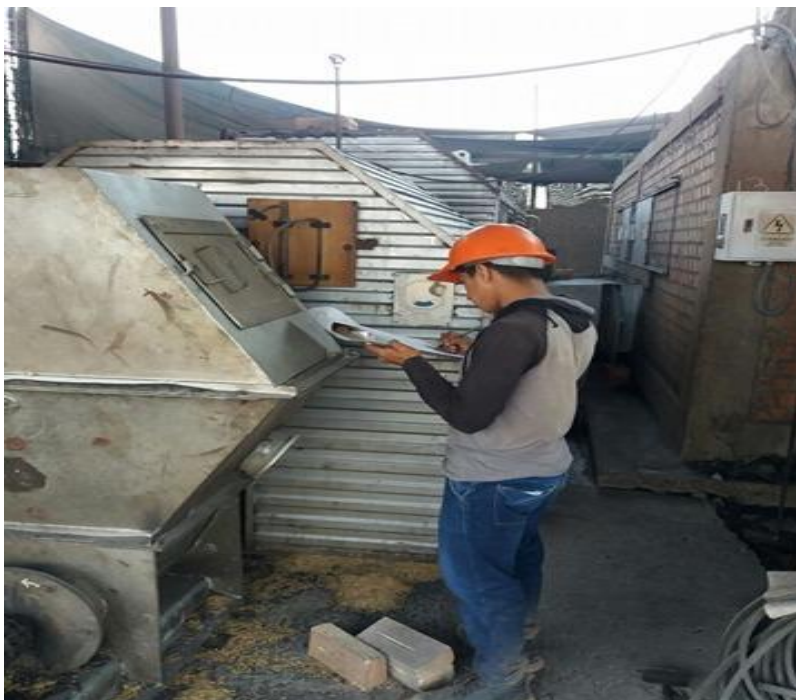
Registro de presión de cámara de combustión
