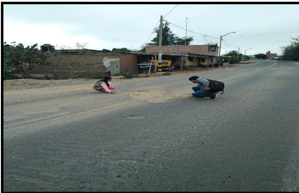
Ilustración N°36: Se observa un hueco en el tramo de la carretera.
