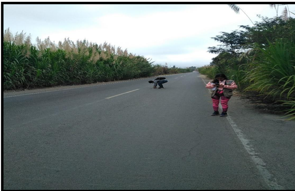
Ilustración N°35: Registro de fallas en la carpeta de rodadura.
