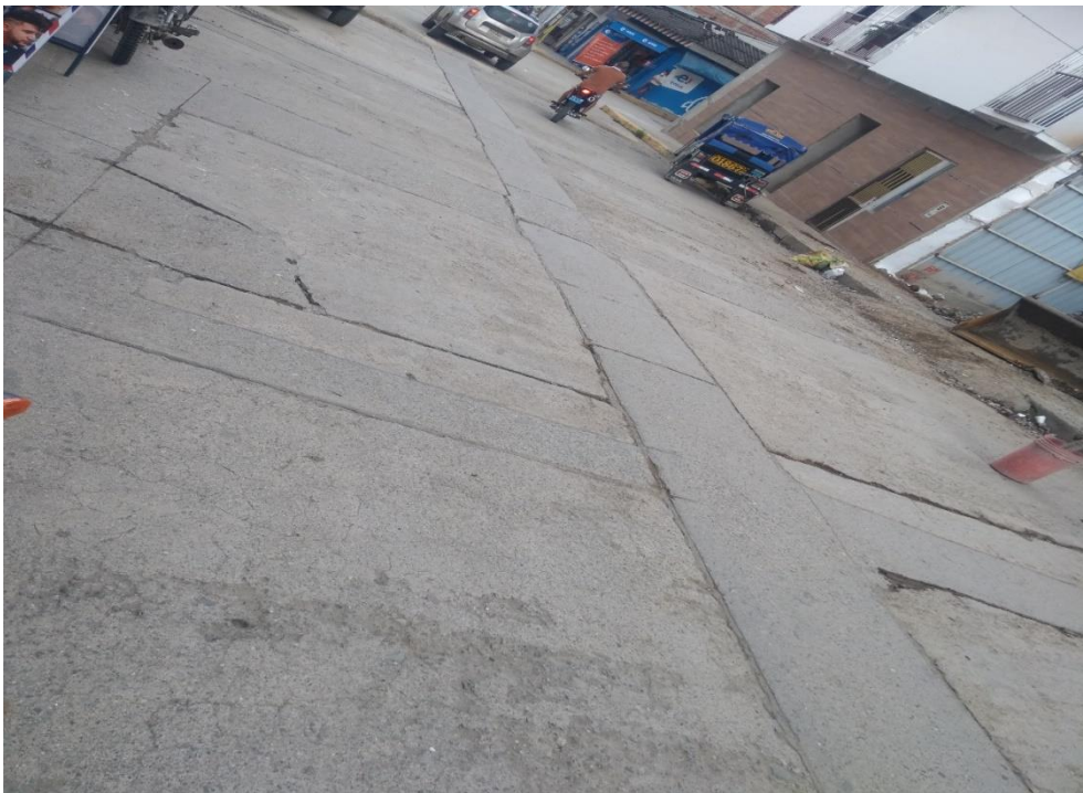
Foto 14: Calle Mariscal Ureta Cuadra 15; agrietamiento en pavimentos relativamente nuevos.
