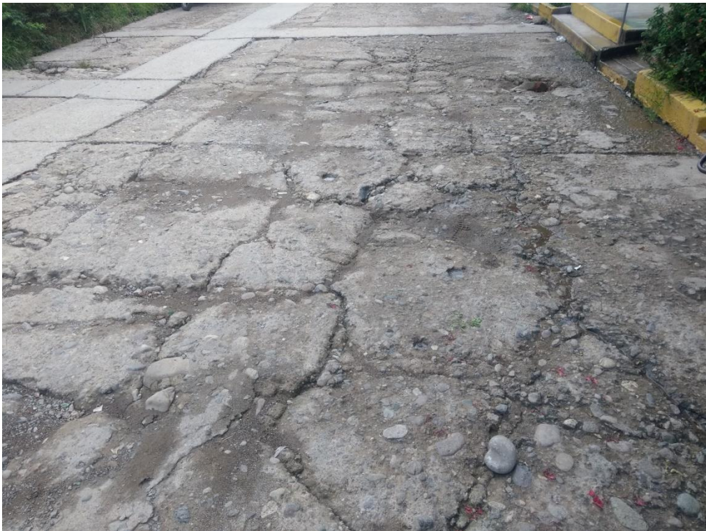
Foto 6: Calle Zarumilla Cuadra 18, la estructura de concreto presenta agrietamiento paralelo al eje de la vía como perpendicular.
