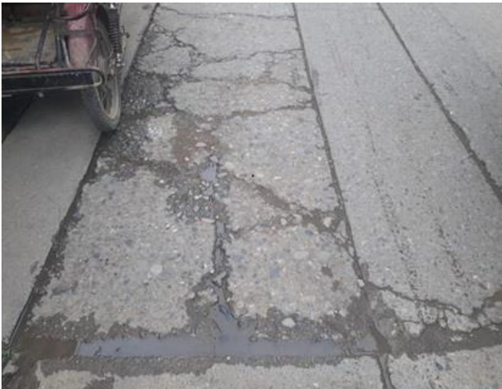
Foto 2: Calle Raymondi Cuadra 01, se observa agrietamiento
