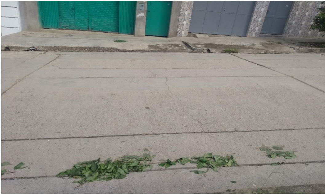
Foto 9: Calle Lambayeque Cuadra 03; de la misma manera se aprecia el agrietamiento del concreto.
