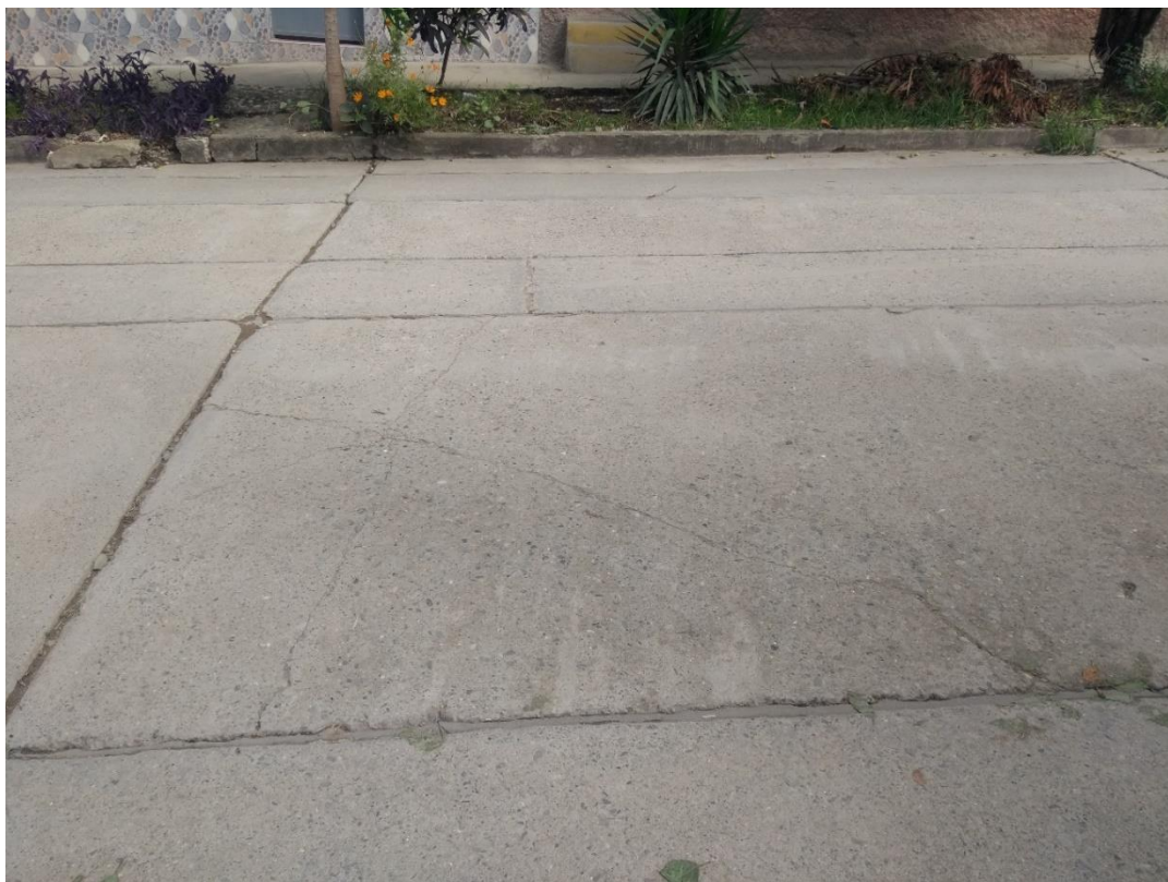
Foto 10: Calle Huamantanga Cuadra 19; observamos la falla del concreto (agrietamiento).
