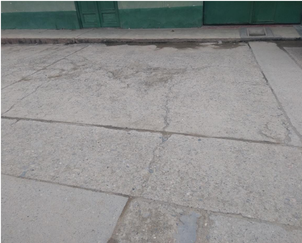
Foto 13: Calle capitán Quiñones Cuadra 01; agrietamiento de losa de concreto con diseño tradicional.
