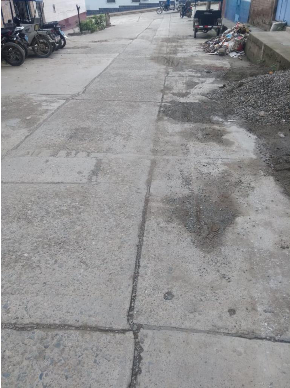
Foto 19: Calle Quiñones Cuadra 1. Se observa que, a un lado de la calzada, de alguna manera se realizó la construcción de losas de menor tamaño a las tradicionales y también se puede apreciar que, a comparación con el carril paralelo no presenta agrietamiento alguno, demostrando de esa manera la importancia del diseño de pavimento con geometría optimizada.
