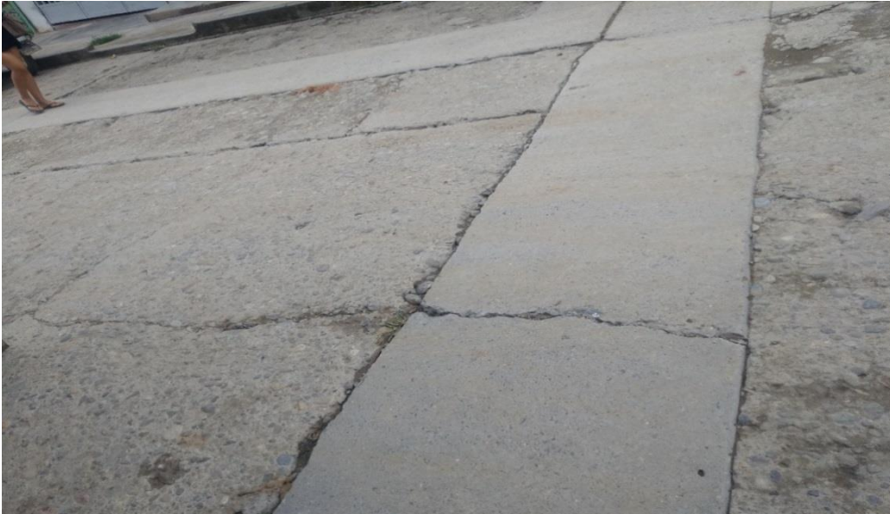
Foto 5: Calle Zarumilla Cuadra 17; agrietamiento del pavimento
