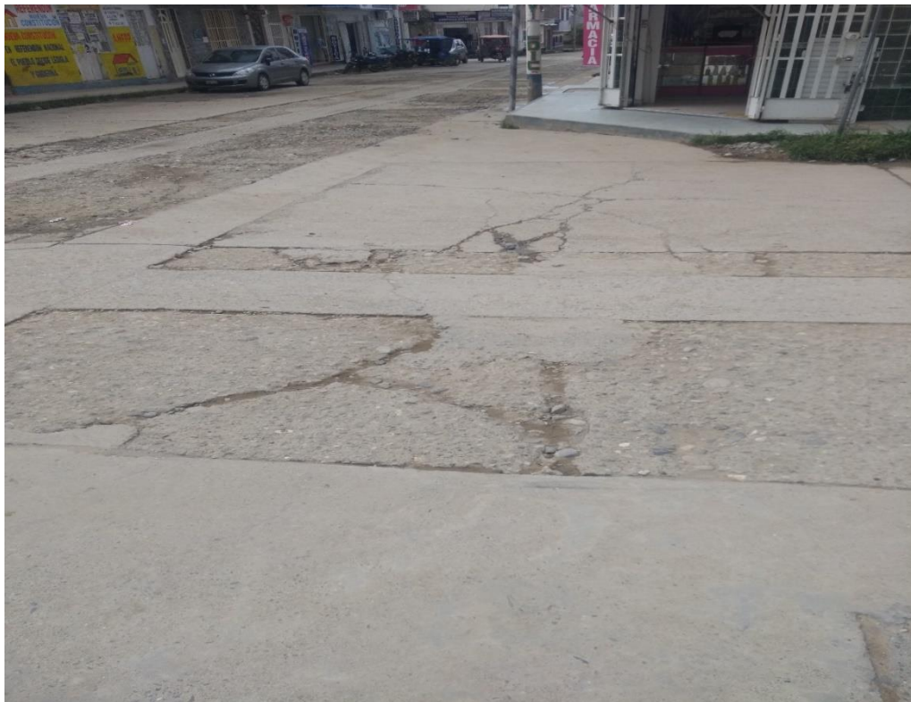
Foto 18: Calle Manco Cápac Cuadra 04; agrietamiento en losa de concreto.
