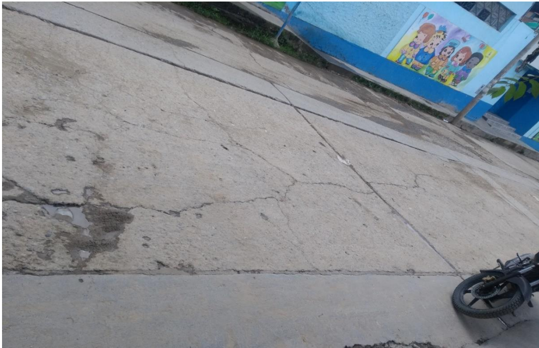
Foto 17: Calle Huamantanga Cuadra 12; agrietamiento paralelo y perpendicular al eje de la vía.
