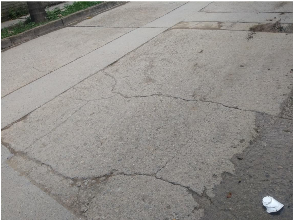
Foto 8: Calle Huamantanga Cuadra 18; se puede observar el agrietamiento en la losa de concreto.
