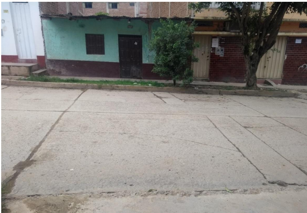
Foto 12: Calle Sucre Cuadra 16; agrietamiento del pavimento con una losa de dimensiones 3.5m*4.0m
