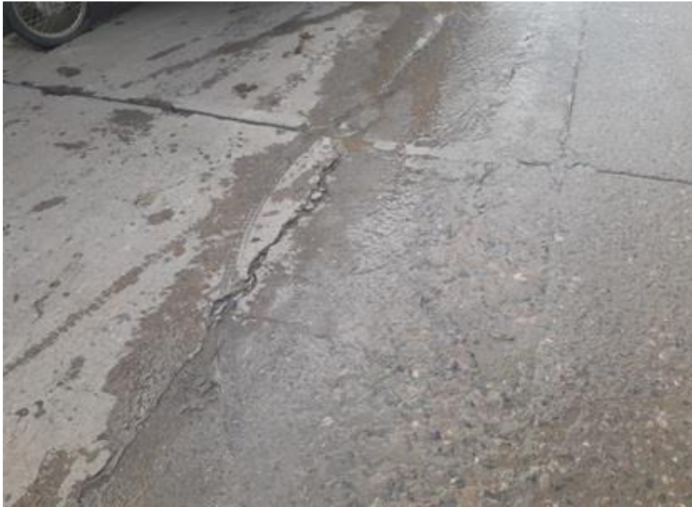
Foto 1: Calle Iquitos Cuadra 16; se observa agrietamiento en la losa de concreto.
