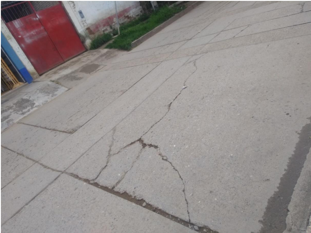
Foto 11: Calle Orellana Cuadra 04; se observa agrietamiento.
