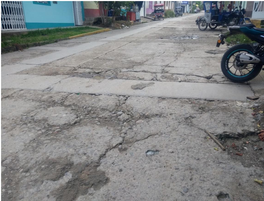
Foto 4: Calle Zarumilla Cuadra 17 (considerada para el estudio); se aprecia agrietamiento en la mayoría de las losas, también se observa desprendimiento del concreto.
