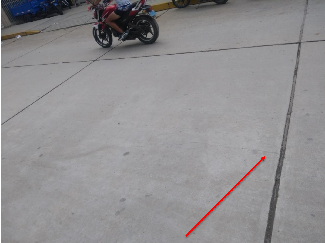
Foto 15 Calle Villanueva Pinillos Cuadra 04; pavimento nuevo (3 años) con indicios de agrietamiento.
