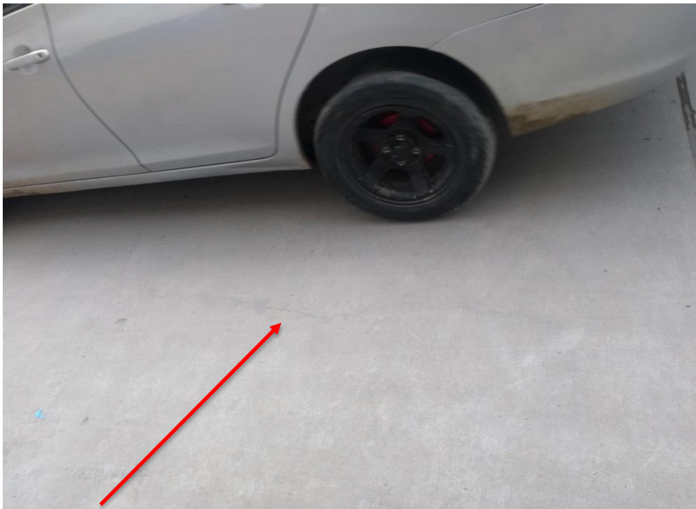
Foto 16: Calle Villanueva Pinillos Cuadra 04; pavimento nuevo (3 años) con indicios de agrietamiento.
