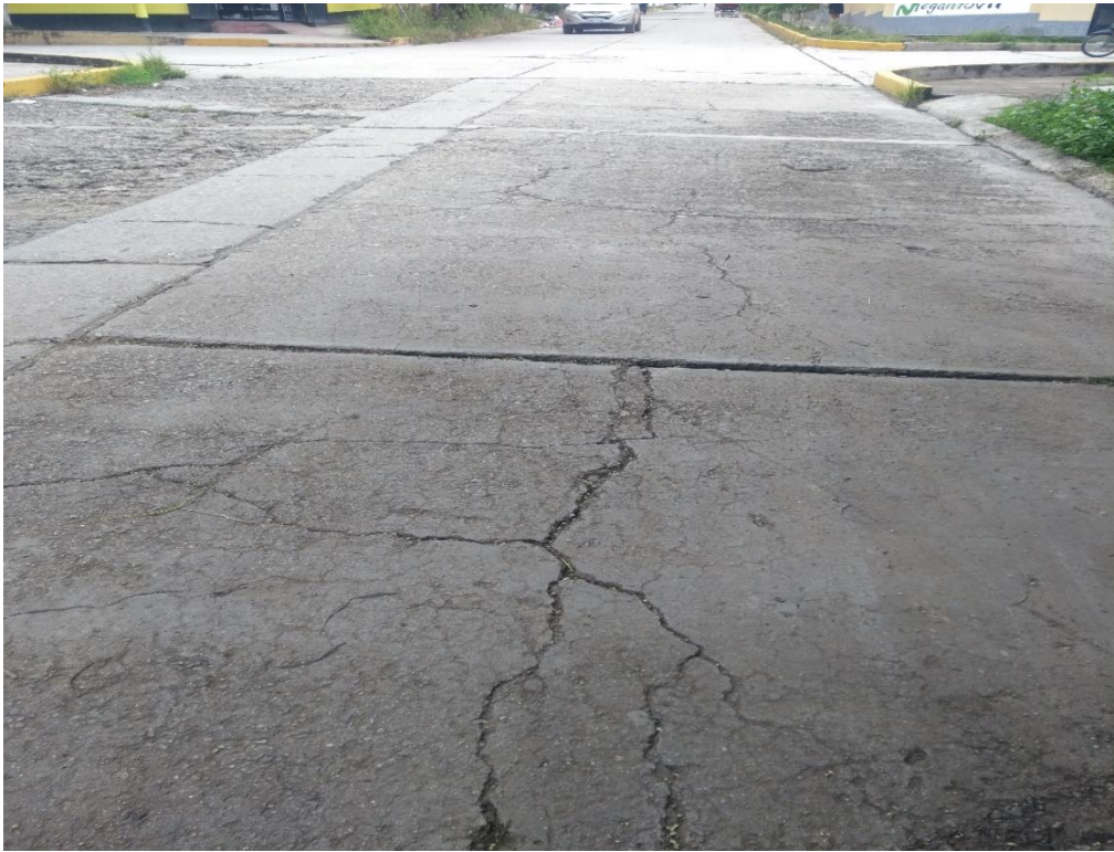
Foto 7: Calle Sucre Cuadra 18; de igual manera se aprecia la falla de agrietamiento del concreto.
