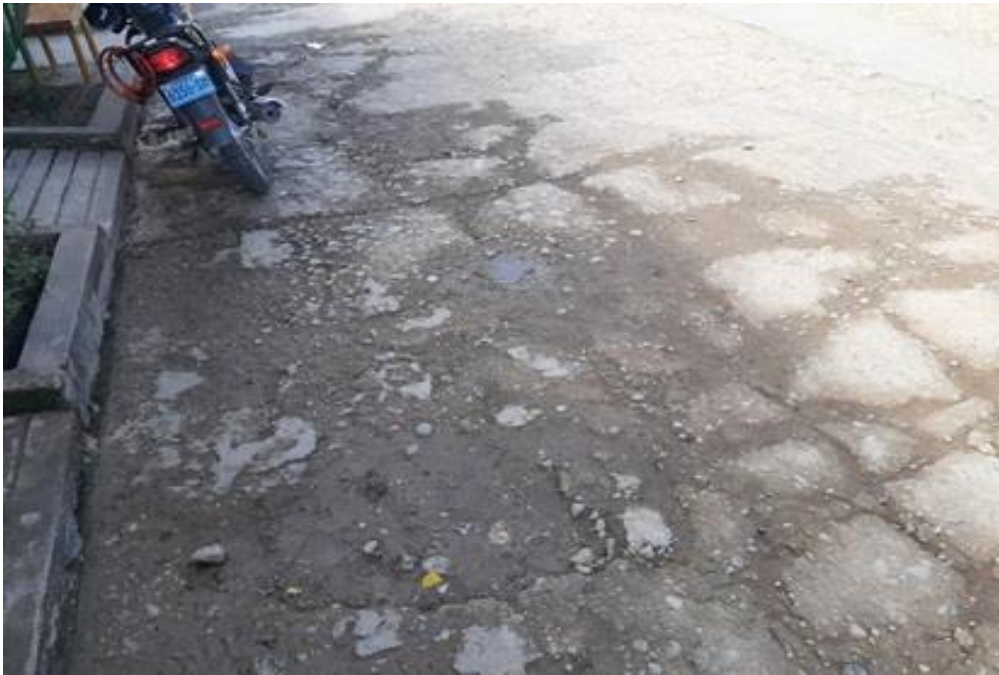
Foto 3: Calle San José Cuadra 01; se aprecia agrietamiento del concreto y por consiguiente desprendimiento del mismo.
