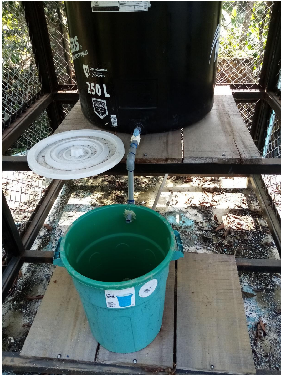
Imagen 3. Sistema de cloración convencional en el tanque de almacenamiento se encuentra sin uso.
