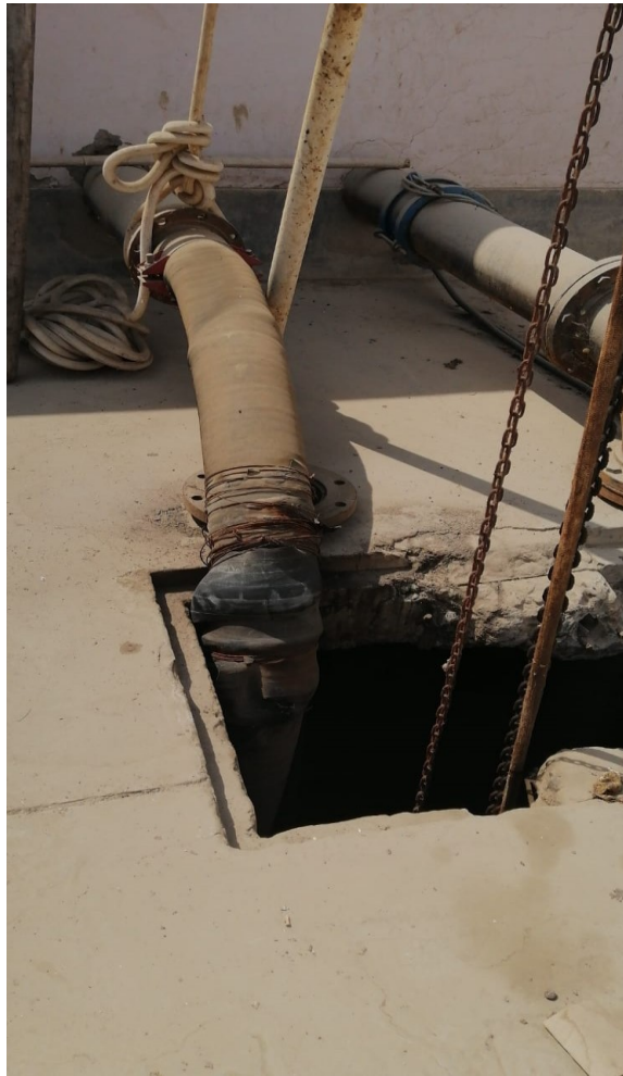
Figura 29. Línea de Impulsión sustituida por mangueras
