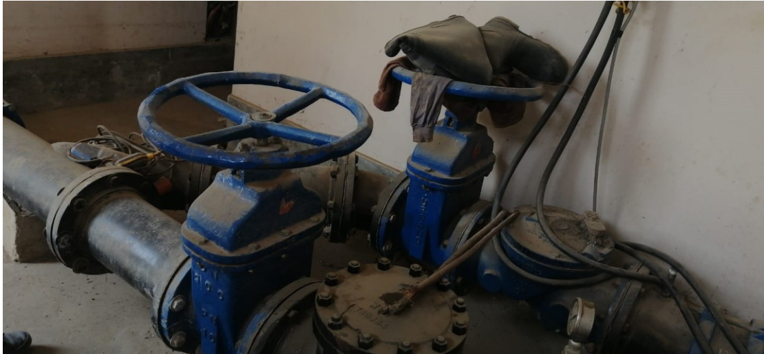
Figura 32. Accesorios de línea de impulsión en mal estado
