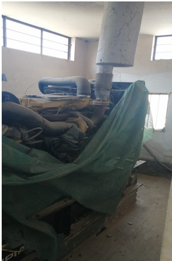
Figura 33. Grupo electrógeno obsoleto
