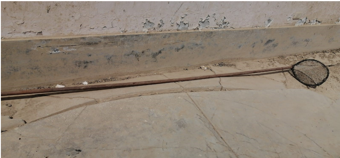
Figura 28. Sistema de Limpieza Inadecuada
