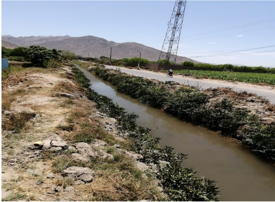
Figura 30. Canal natural sin revestimiento
