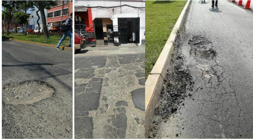
Figura 12. Deterioro o fallas en un pavimento.
