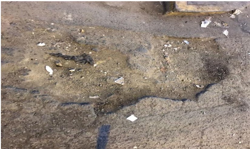
Figura 25: Baches en el pavimento.
