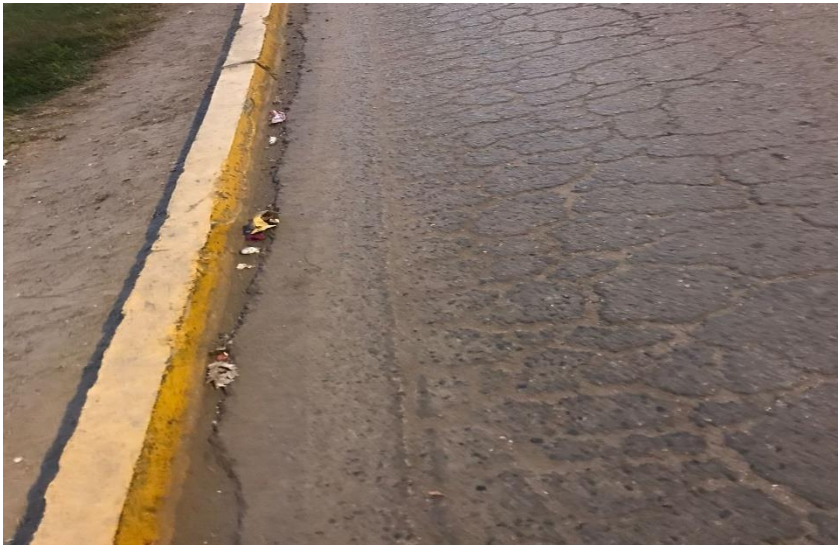
Figura 26: Grieta al borde del pavimento.
