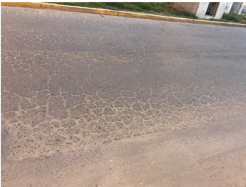
Figura 27: Parche en el pavimento.
