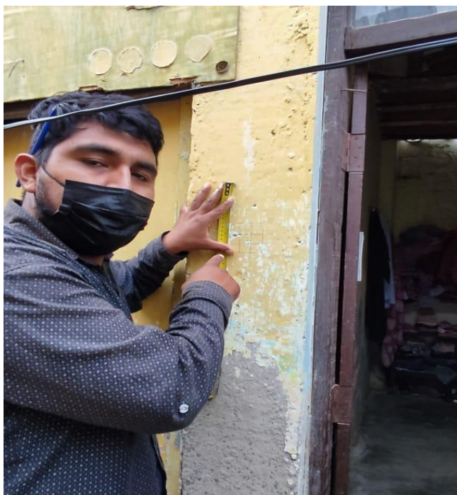
FOTO 12: Aplicación del ensayo de esclerometría en Viga 01 de la vivienda ubicada en Psje. Ramón Castilla Mz. 19 Lt. 15.
