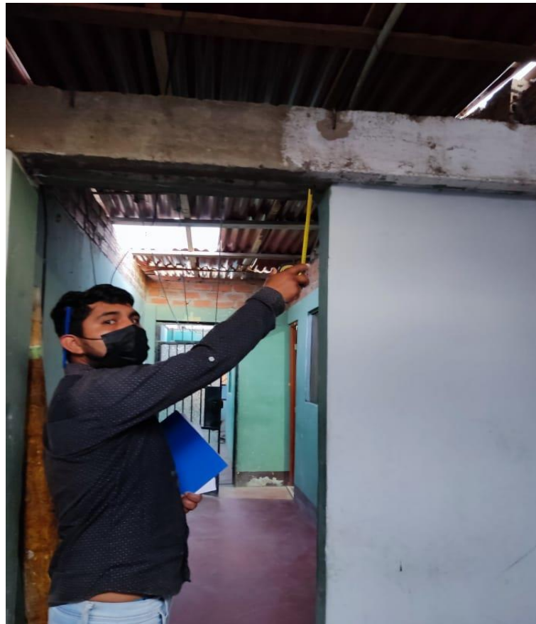
FOTO 25 y 26: Viga empotrada en muro en las viviendas del A.H. Miraflores Bajo.
