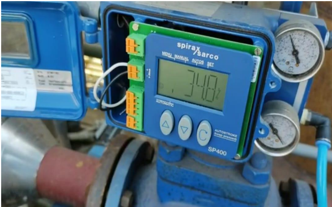
Válvula electroneumática de vapor en funcionamiento
