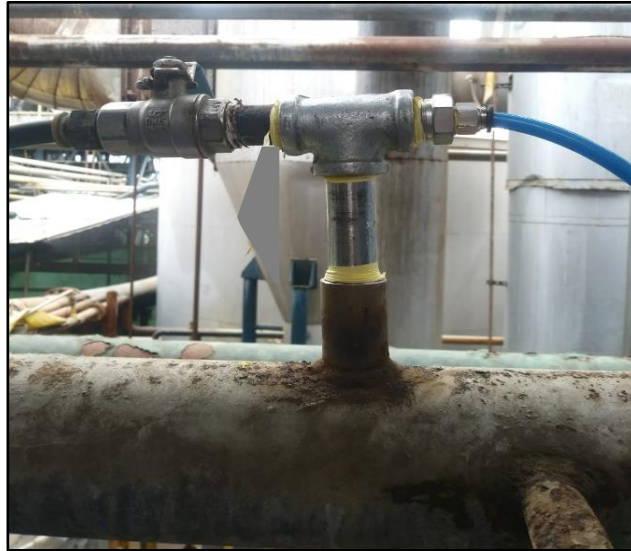
Figura 11. Instalación mecánica del niple, T, con su reducción que llega hacia el FR Fuente: (Elaboración propia)
