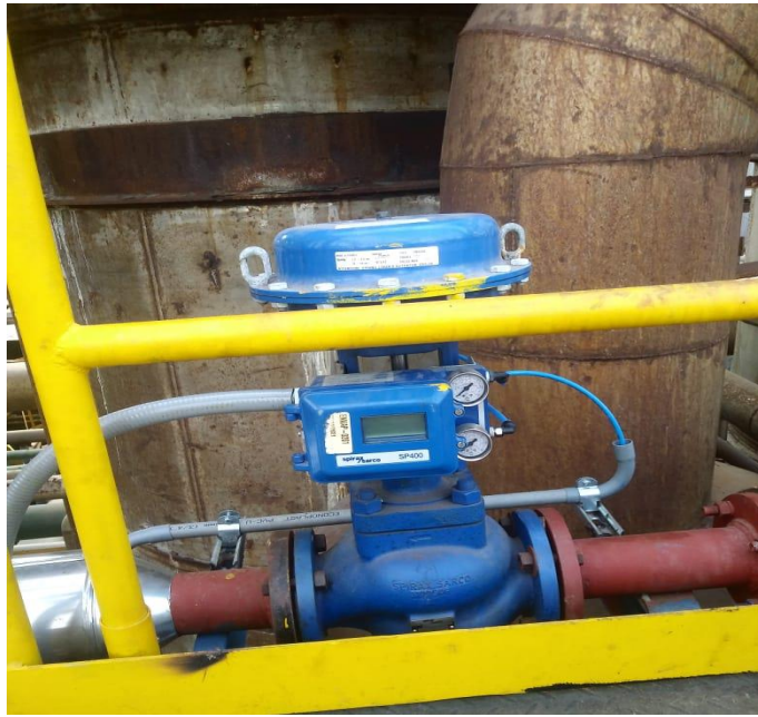
Instalación eléctrica y neumática del posicionador.
