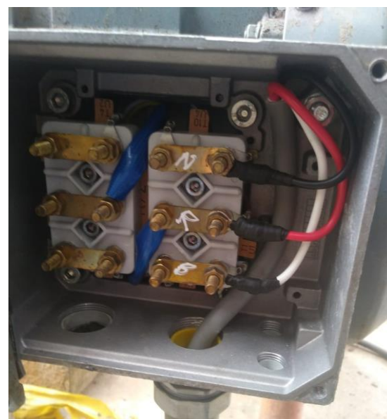
Conexión del motor eléctrico
