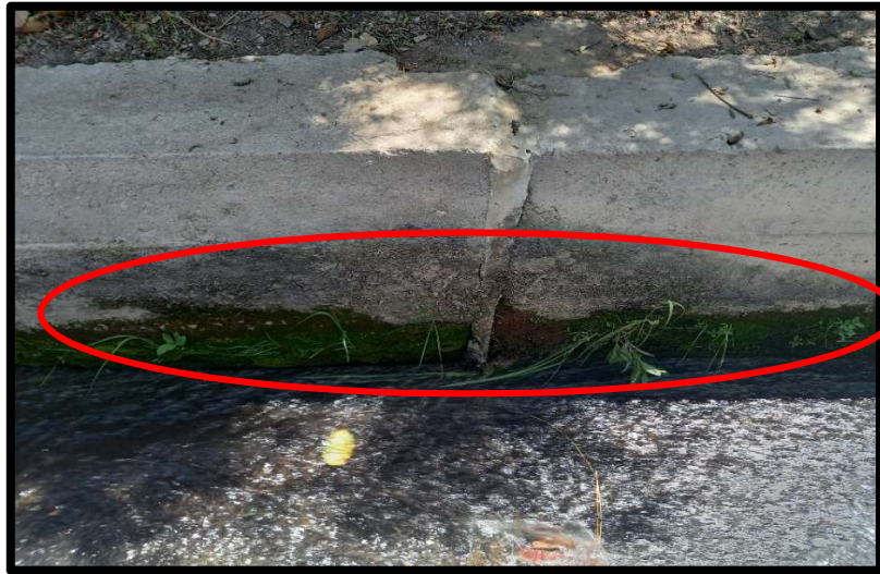
Figura 1. Presencia de vegetacion y moho en el canal
