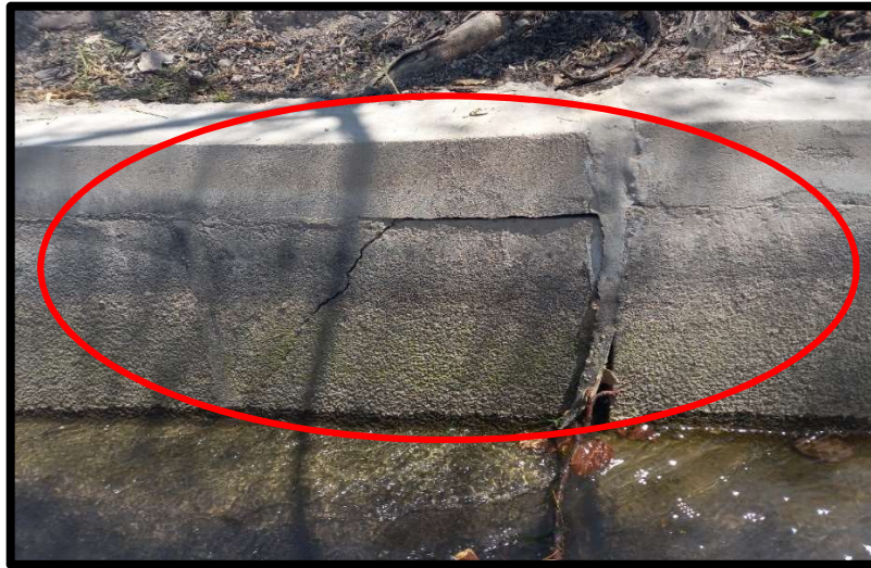
Figura 2. Erosión y desgaste en el canal
