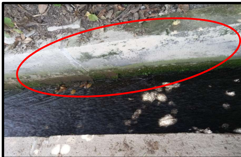
Figura 4. Precencia de eflorescencia en la seccion de canal
