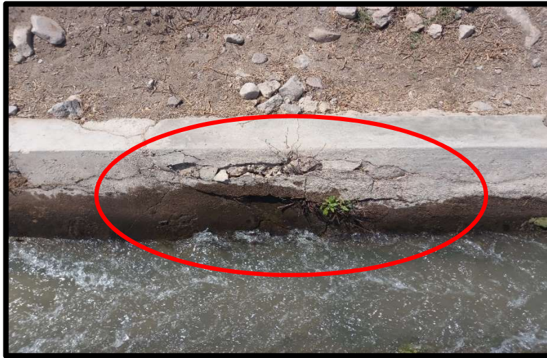
Figura 3. Inicio de desprendimientos de concreto en el canal
