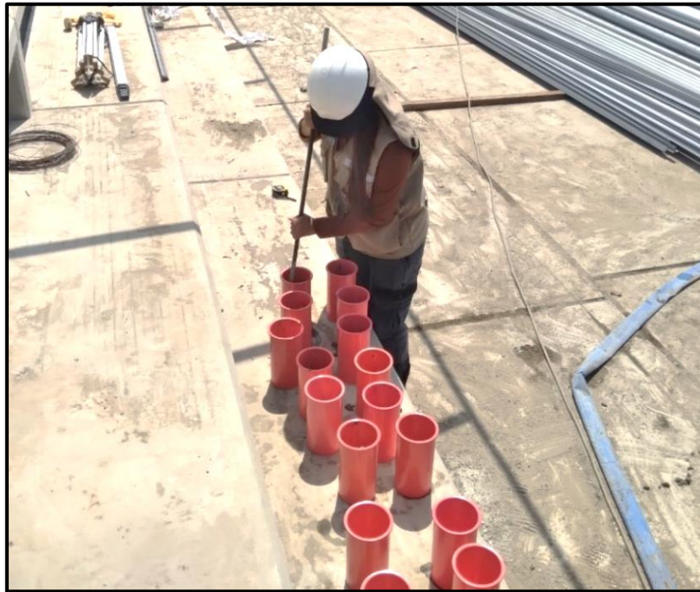
FOTO N°19: Vaciado de concreto f'c 175 kg/cm 2 y f'c 210 kg/cm 2 con agua potable en moldes de probetas.
