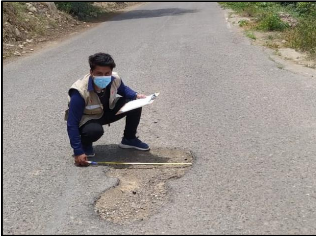
Figura 3: Falla (Hueco m2)
