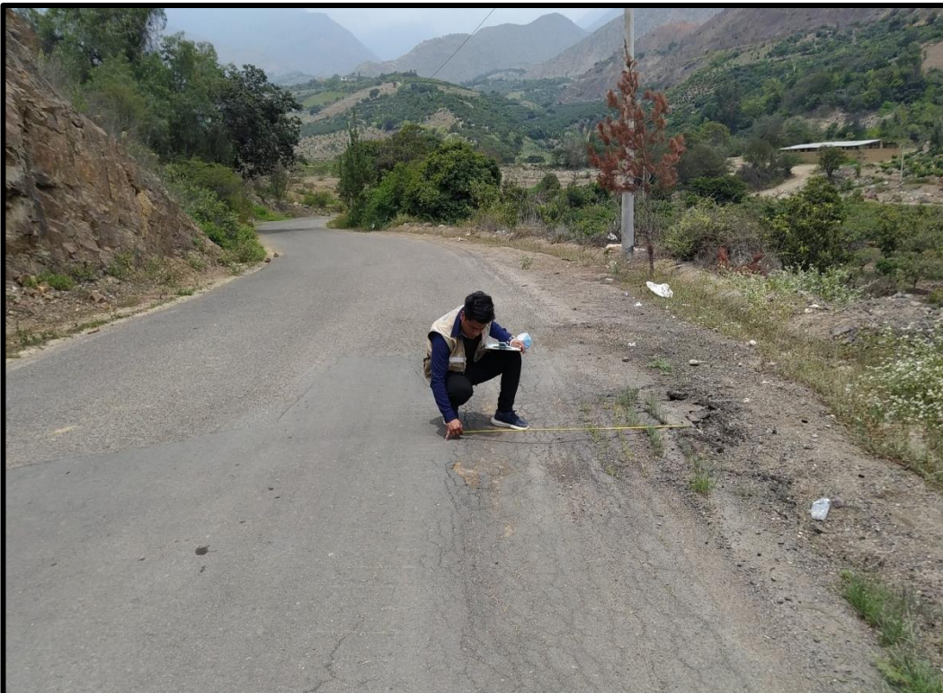
Figura 8: Falla (piel de cocodrilo m2)
