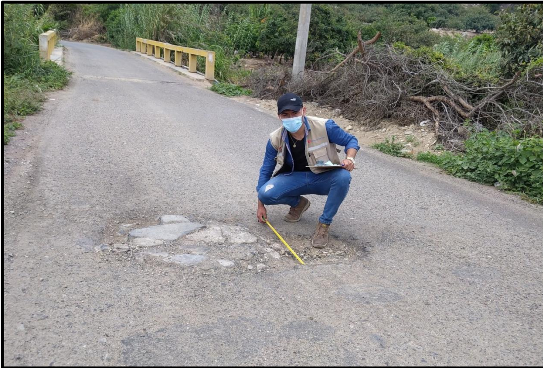
Figura 9: Falla (Huecos m2)
