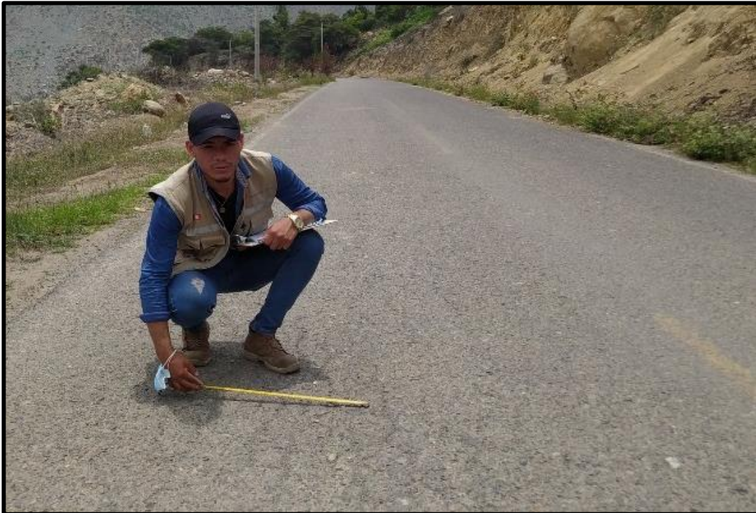
Figura 5: Falla (Ahuellamiento m)
