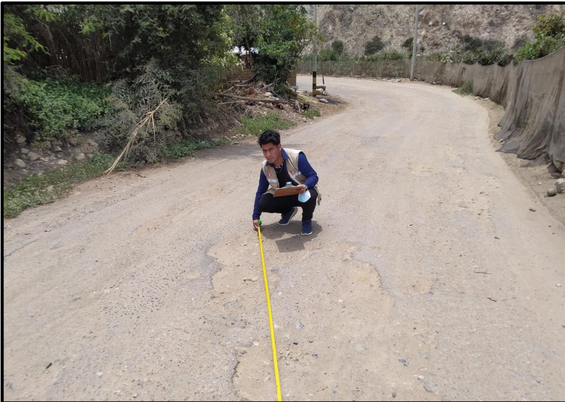
Figura 10: Falla (huecos m2)
