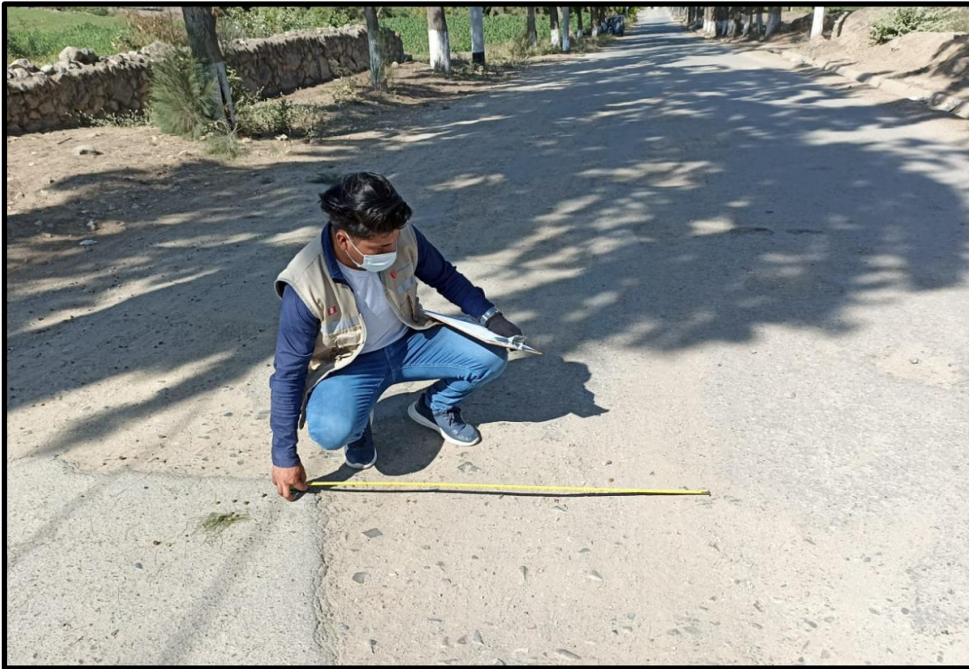
Figura 11: Falla (Huecos m2)
