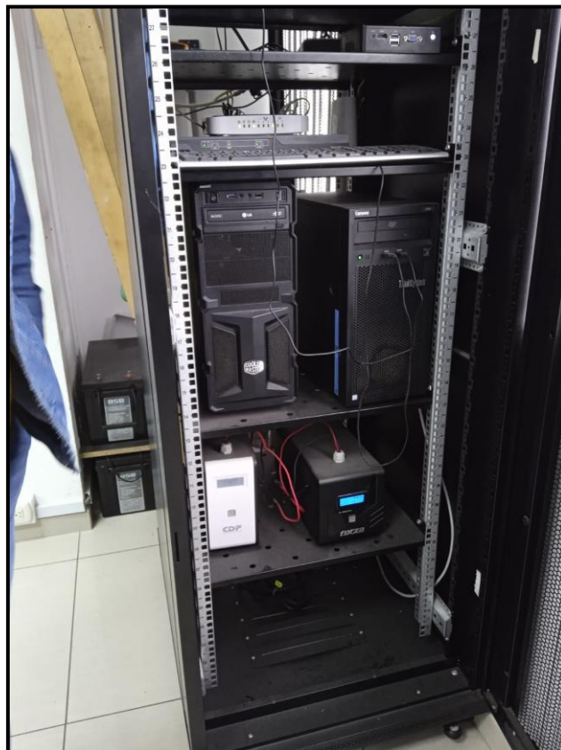
Figura 23. Rack de comunicaciones
