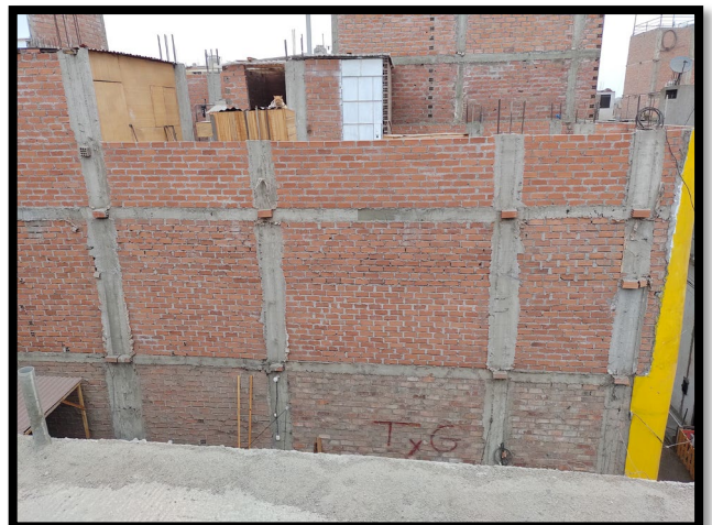
FOTO 4: Parapetos sin viga de confinamiento.
