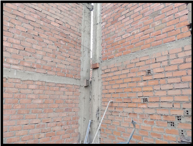
Foto 1: Desnivel entre losas
