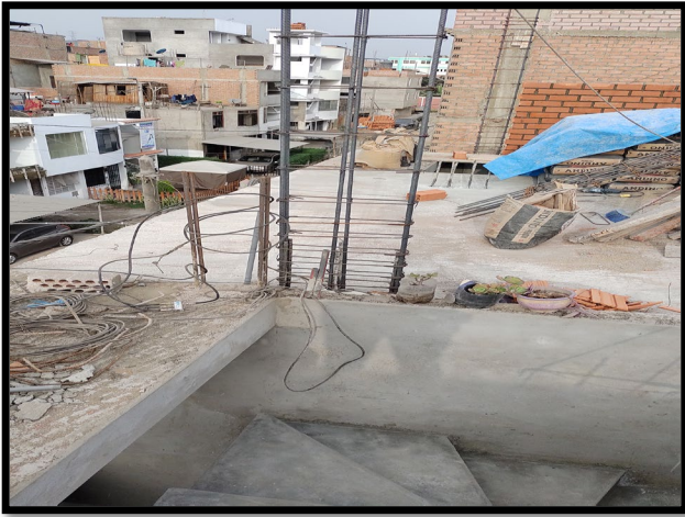
FOTO 5: Ausencia de viga en eje "X"
