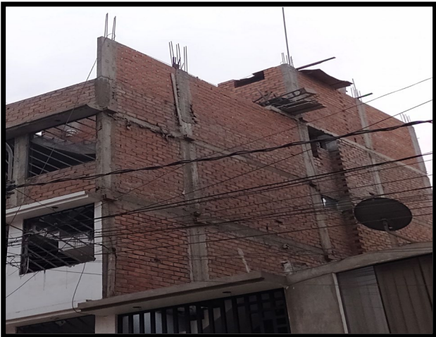
FOTO 3: Muro perimetral sin arrioste horizontal
