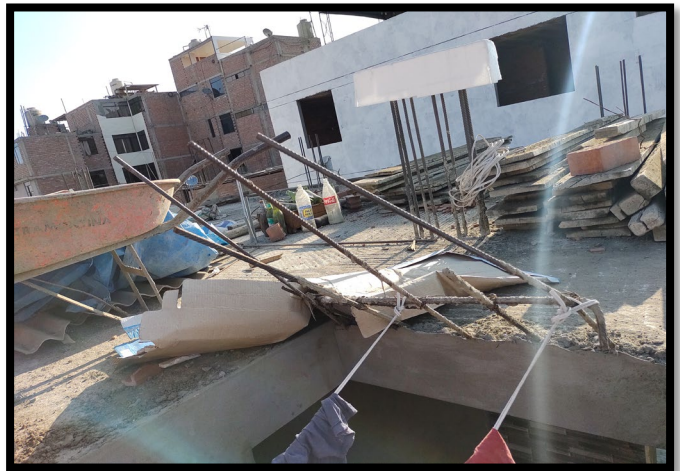
FOTO 6: Discontinuidad de Losa
