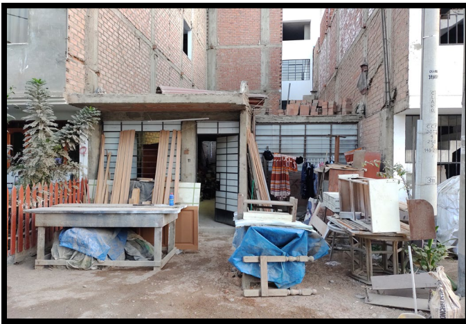
FOTO 15: Vivienda de 1 piso con ausencia de viga chata.
