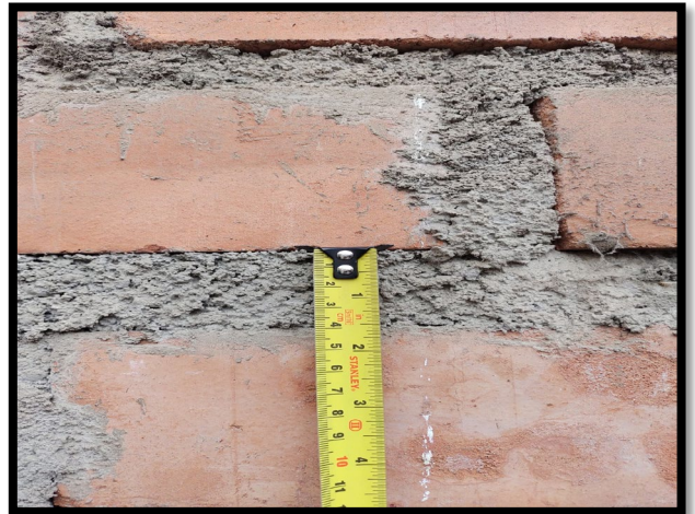
FOTO 2: espesor de junta
