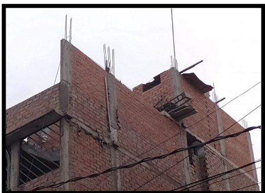
Figura 10. Muro sin arriostre horizontal
