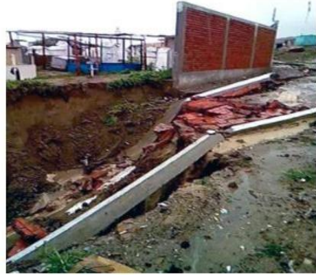
TALARA. Las paredes del cerco del cementerio San Pedro, el más antiguo de la ciudad, cayeron al recibir el impacto del torrente de una de las quebradas. Los fuertes aguaceros han inundado toda la urbe ( Ingrid Silva A. )
