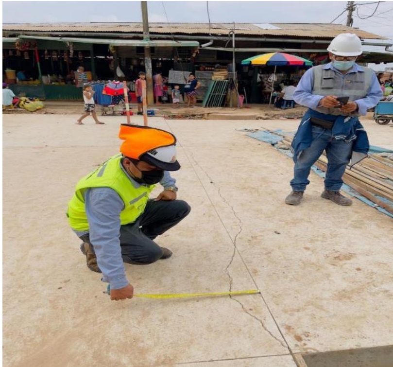
Figura 1: Deterioro del pavimento en Colombia
