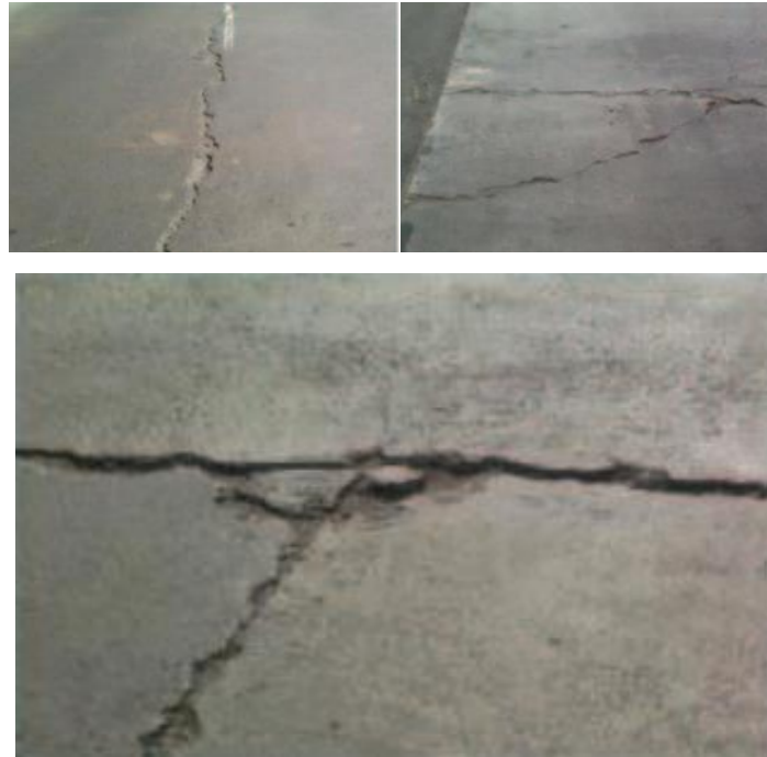
Figura 2: Deterioro del pavimento en Perú
