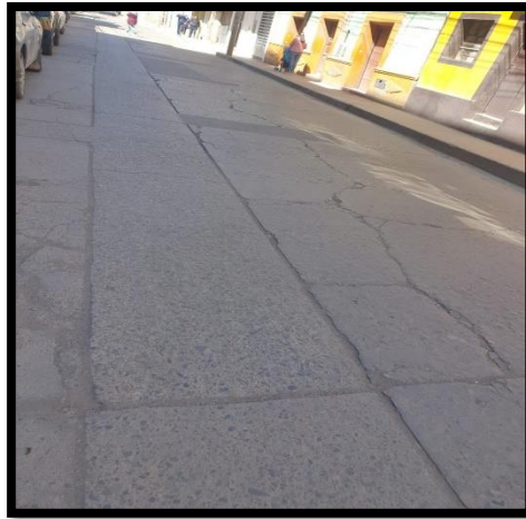
Figura 1. situación actual de los pavimentos de concreto en Puno.
