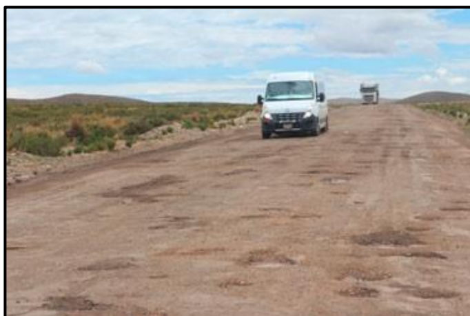
Figura 02. Vías deterioradas en el distrito de Caracoto
