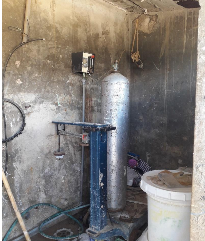
Sistema de cloración por Inyección Directa con cloro gas
