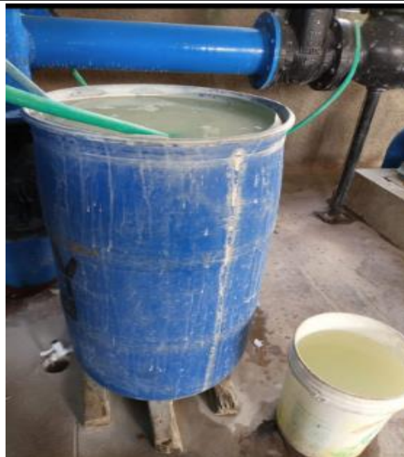
Sistema de cloración por goteo
