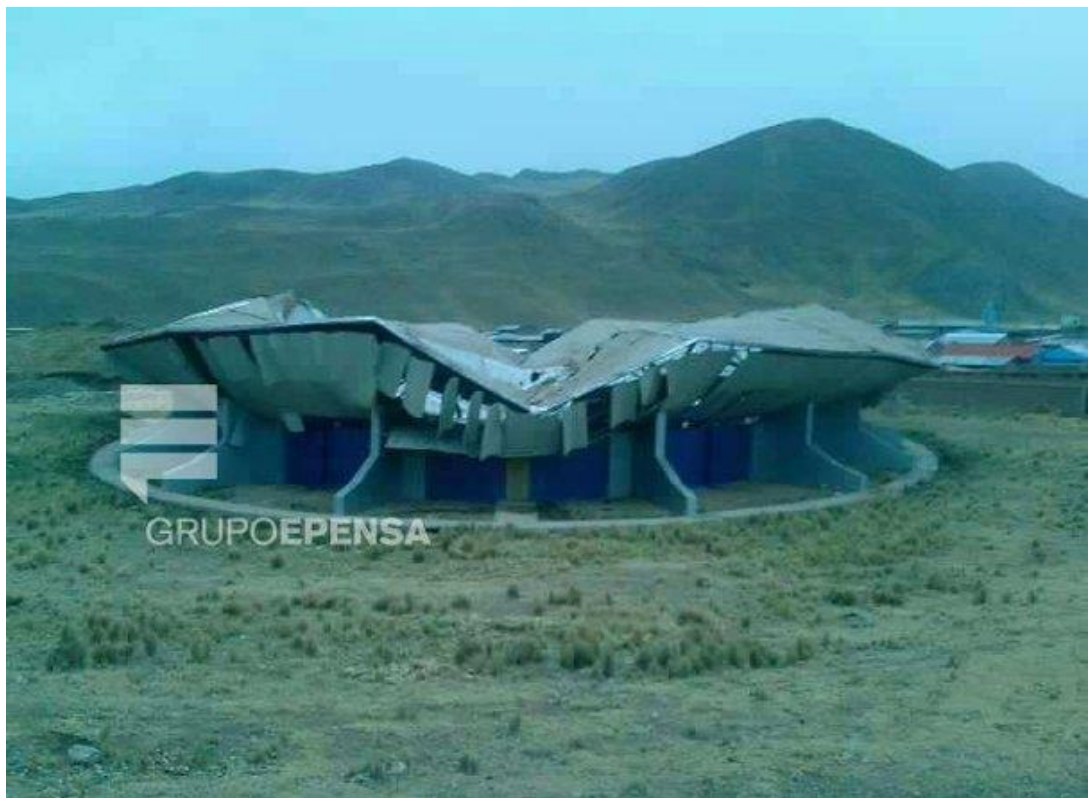
Figura 2: El techo del coliseo que se encuentra en la ciudad de la oroya término colapsando por la fuerte caída de nevado. Fuente: Diario Correo
