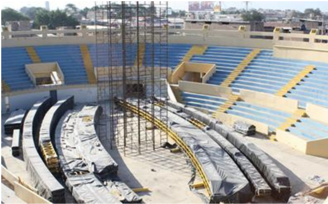
Figura 1: Observamos el incumplimiento de la obra del techo del Coliseo Cerrado de Sullana por deficiencia en el Diseño Estructural. Fuente: Red de comunicación Regional
