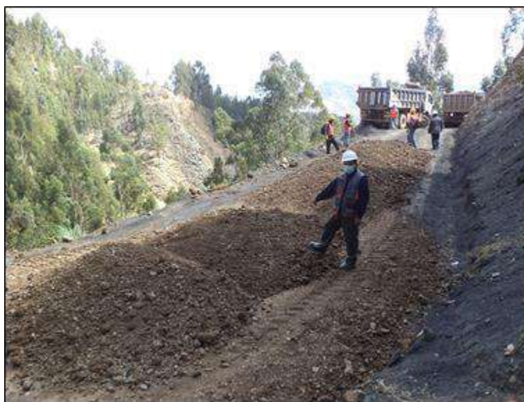
Foto N° 34: El Ing. Residente mostrando el material granular de préstamo para capa nivelante antes las labores de esparcido con motoniveladora, progresiva 9+600. Martes 13/10/2,020, coordenadas UTM: E=213,505.2309 N=9'053,613.9099.
