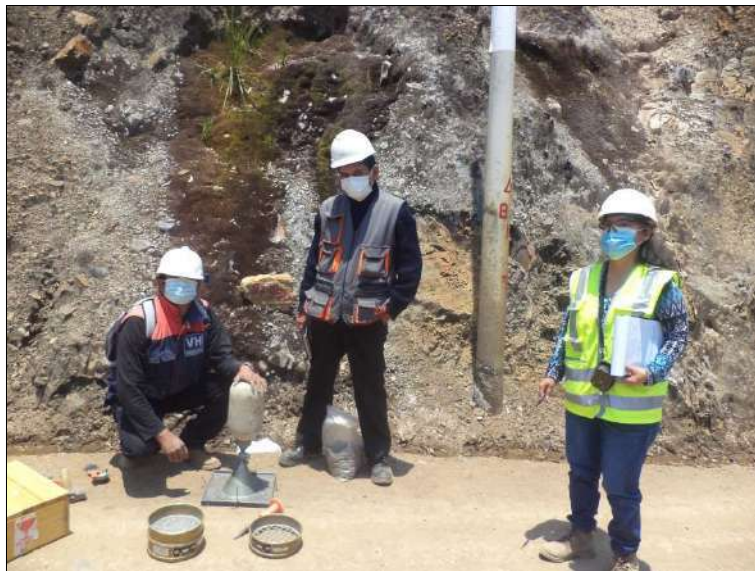
Foto N° 46: Visita técnica, verificación del ensayo densidad de campo, de izquierda a derecha: Técnico de mecánica de suelos, Ing. Residente, Ing. del I.V.P. progresiva 9+950. Lunes 02/11/2,020, coordenadas UTM: E=213,771.8145 N=9'053,798.5383.
