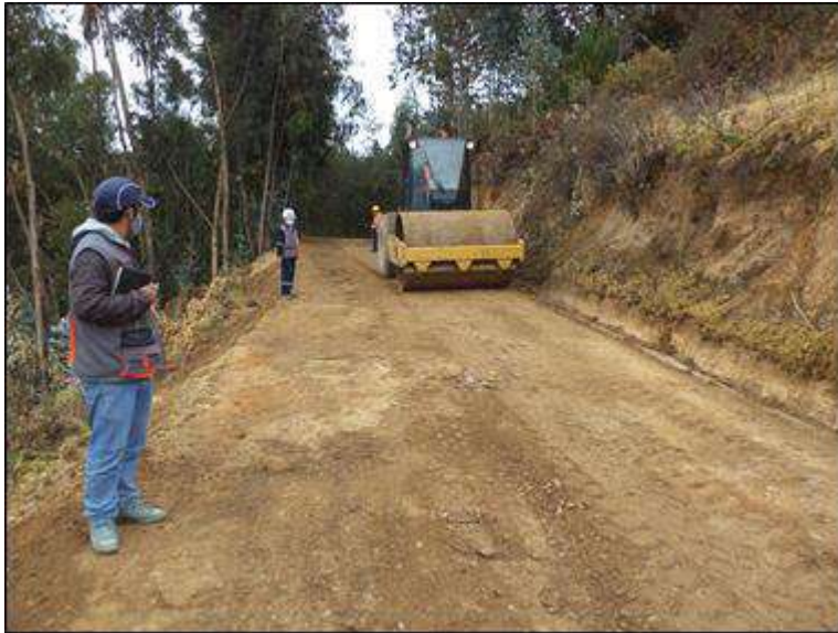
Foto N° 11: Personal del plantel técnico de la contrata, maestro y coordinador del servicio, verificando los trabajos de compactado de la sub rasante con la maquinaria rodillo liso vibratorio. Miércoles 07/10/2,020, coordenadas UTM: E=214,700.3684 N=9'053,479.7656.
