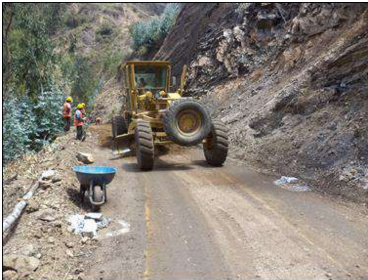
Foto N° 40: Vista del emplantillado y esparcido de material granular de afirmado E = 0.15 m con motoniveladora, progresiva 10+200. Lunes 19/10/2,020, coordenadas UTM: E=213,749.9339 N=9'053,634.0315 .
