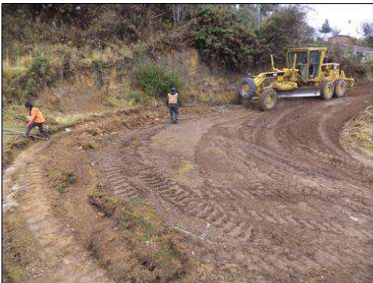
Foto N° 12: Trabajo de perfilado de superficie y reconfiguración de cuneta con motoniveladora a nivel de sub rasante. Miércoles 07/10/2,020, coordenadas UTM: E=214,692.0338 N=9'053,433.1620.
