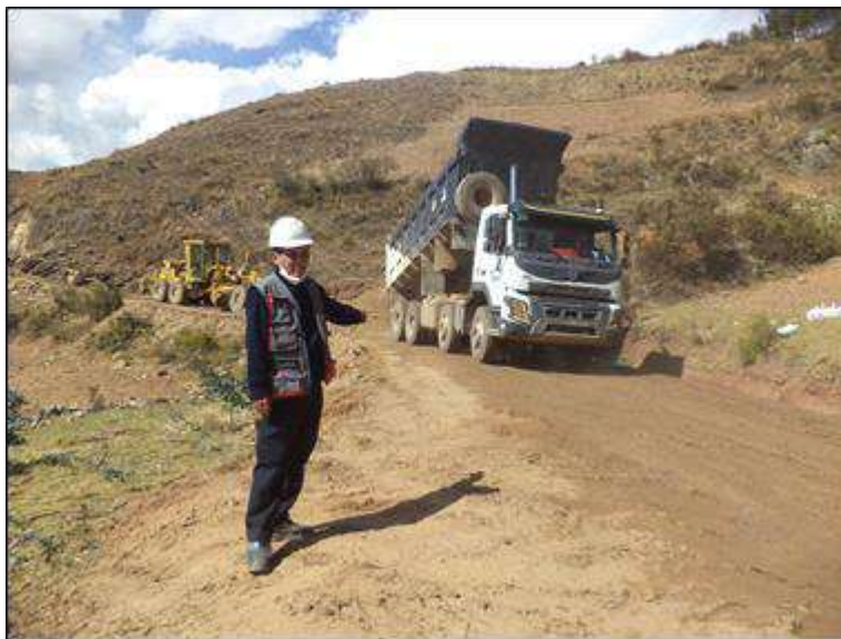
Foto N° 42: El Ing. Residente señalando la descarga del material granular de cantera para afirmado E = 0.15 m, progresiva 11+200. Lunes 26/10/2,020, coordenadas UTM: E=213,984.6854 N=9'052,795.3707.
