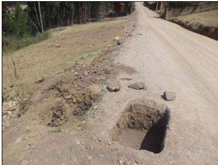
Foto N° 50: Vista de la excavación de zapatas para señal informativa, de código I – 5, SAURAPA, progresiva 10+600. Sábado 07/11/2,020, coordenadas UTM: E=213,783.1819 N=9'053,324.9597.
