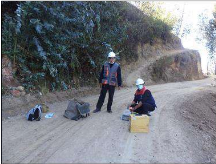
Foto N° 41: El Ing. Residente y el técnico de mecánica de suelos en la prueba de densidad de campo con Speedy, progresiva 14+290. Lunes 19/10/2,020, coordenadas UTM: E=214,707.0338 N=9'053,525.0695.
