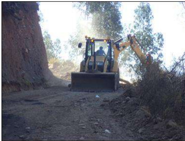
Foto N° 26: Vista de la retroexcavadora en trabajos de arrastre de material al centro de la superficie para posterior nivelación y compactado, progresiva 3+100. Sábado 10/10/2,020, coordenadas UTM: E=211,790.0016 N=9'052,882.3174.
