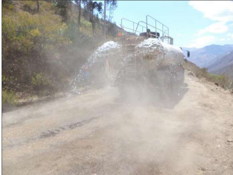
Foto N° 29: Trabajos de aspersion con camión cisterna a nivel de sub rasante con la maquinaria rodillo liso vibratorio, progresiva 0+700. Lunes 12/10/2,020, coordenadas UTM: E=211,614.0324 N=9'052,591.6654.
