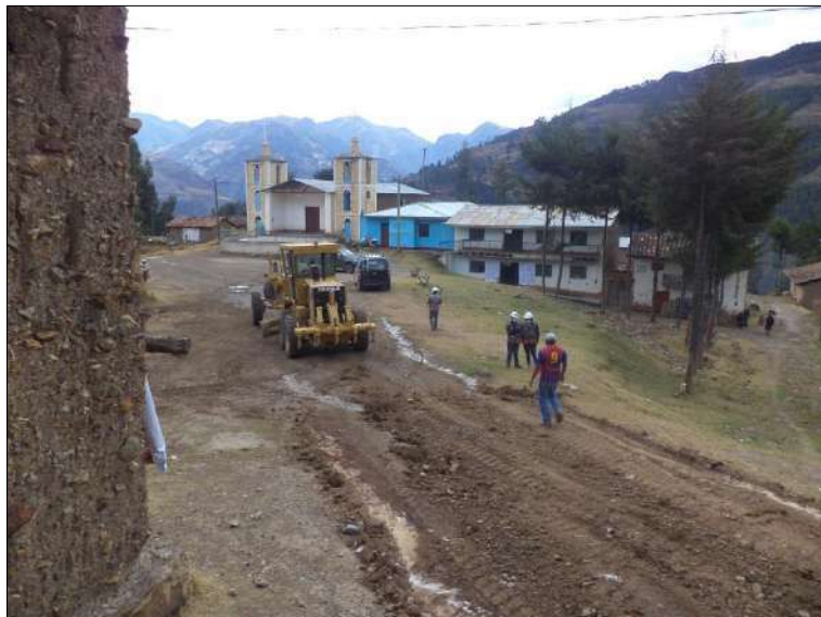
Foto N° 20: Vista del perfilado con motoniveladora a nivel de sub rasante en el área de plaza del C.P. Usamasanga, progresiva 7+150. Sábado 10/10/2,020, coordenadas UTM: E=212,038.5676 N=9'053,935.2747.
