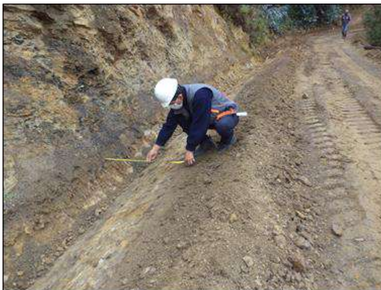
Foto N° 10: El Ingeniero Residente del Servicio, verificando las dimensiones de la reconfiguración de cuneta. Miércoles 07/10/2,020, coordenadas UTM: E=214,712.2985 N=9'053,512.1476.
