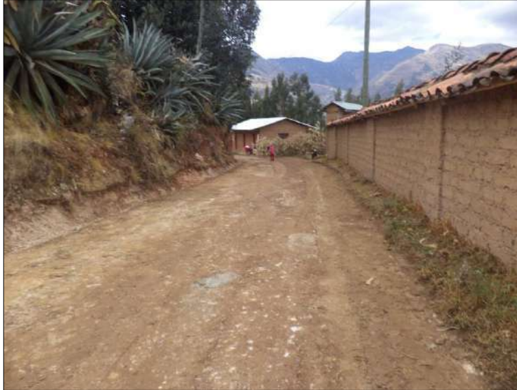
Foto N° 23: Vista del compactado de la sub rasante y reconfiguración de cunetas, progresiva 6+900. Sábado 10/10/2,020, coordenadas UTM: E=211,827.7212 N=9'053,798.8485.
