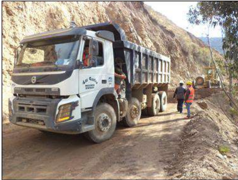
Foto N° 37: Vista de puesta en obra del material granular de cantera afirmado E = 0.15 m, progresiva 9+400. Miércoles 14/10/2,020, coordenadas UTM: E=213,314.6203 N=9°053,604.9720.
