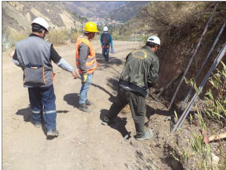
Foto N° 28: El maestro de obra supervisando los trabajos de reparación de rotura de tuberías superficiales, durante los trabajos de reconfiguración de cuneta a nivel de sub rasante con motoniveladora, progresiva 0+700. Lunes 12/10/2,020, coordenadas UTM: E=211,614.0324 N=9'052,591.6654.
