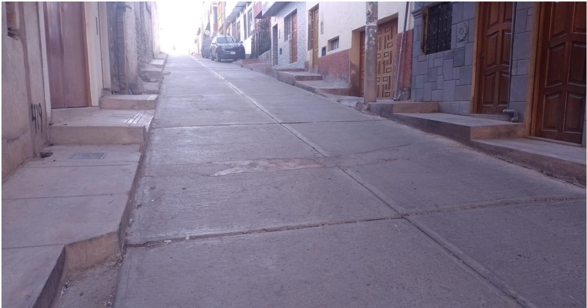
Fotografía 6. Estado de pavimento Jr. Salcedo cuadra 1 en la ciudad de Puno.
