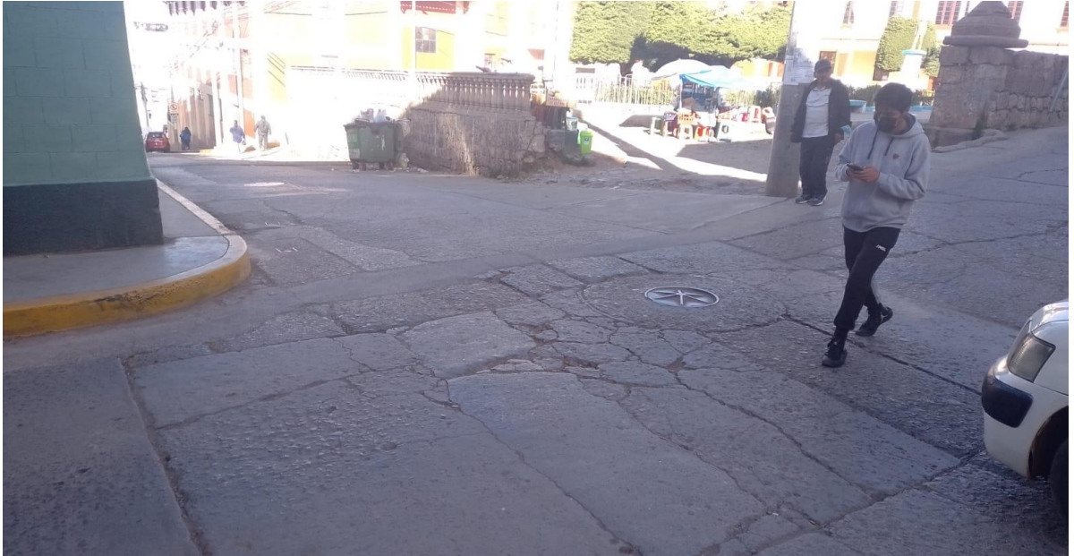
Fotografía 1: Estado de pavimento Jr. Lima esquina con Jr. Huancané en la ciudad de Puno.
