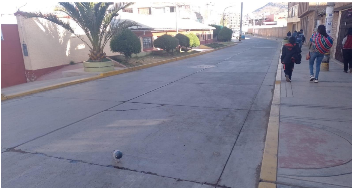
Fotografía 2. Estado de pavimento Jr. Ilo cuadra 1 en la ciudad de Puno
